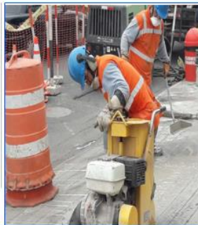
Uso inadecuado del respirador KN95
