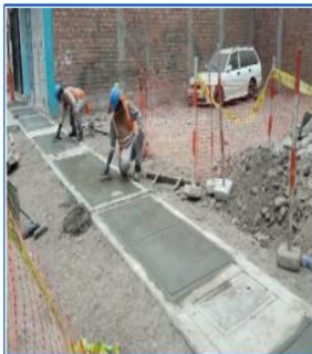
Uso de guantes de jebe en mal estado (con agujeros)
