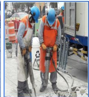
Uso inadecuado del respirador KN95
