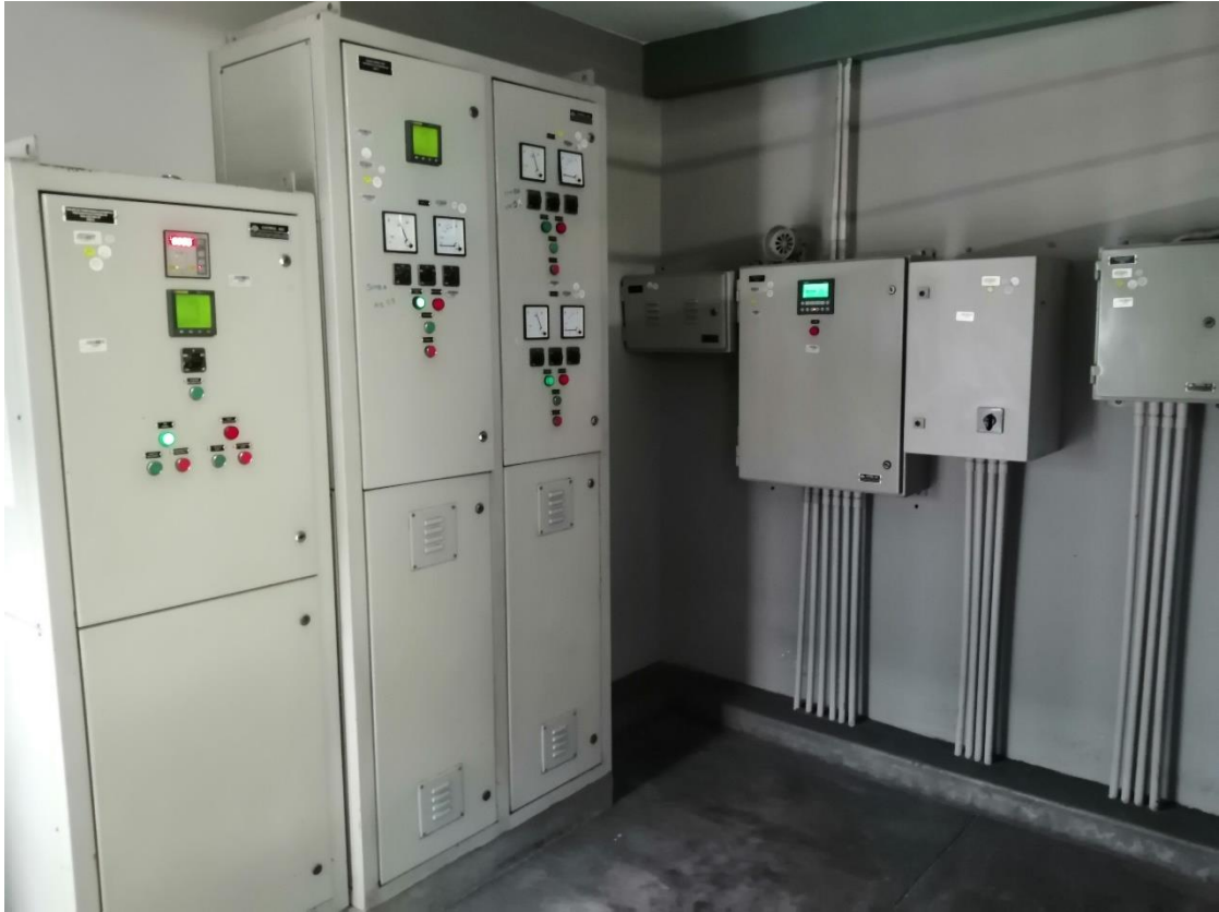
Figura 61. Tablero de bomba y motores
