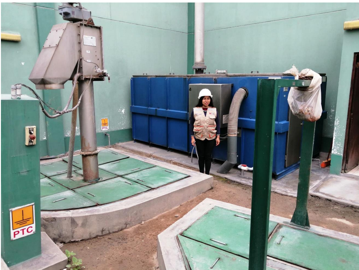
Figura 60. Visita a la Estación de bombeo CD-79
