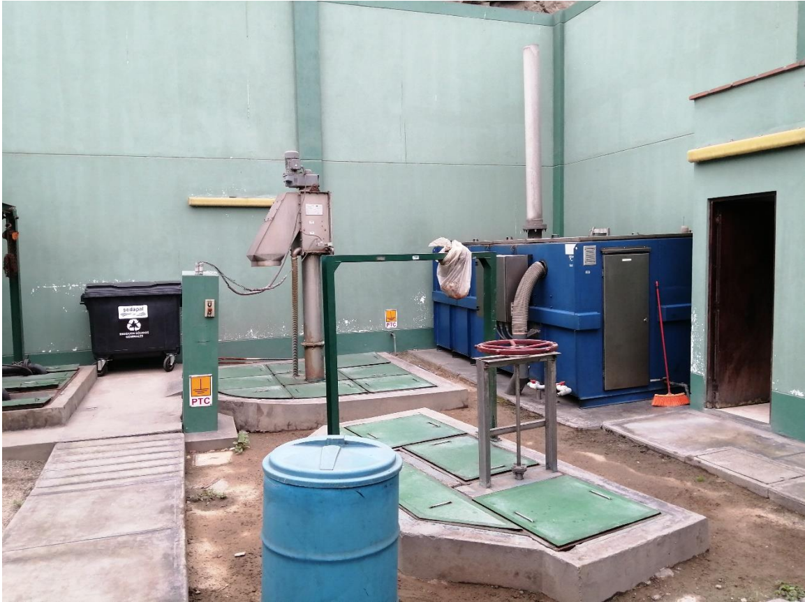
Figura 59. Equipos de estación de bombeo de desagüe
