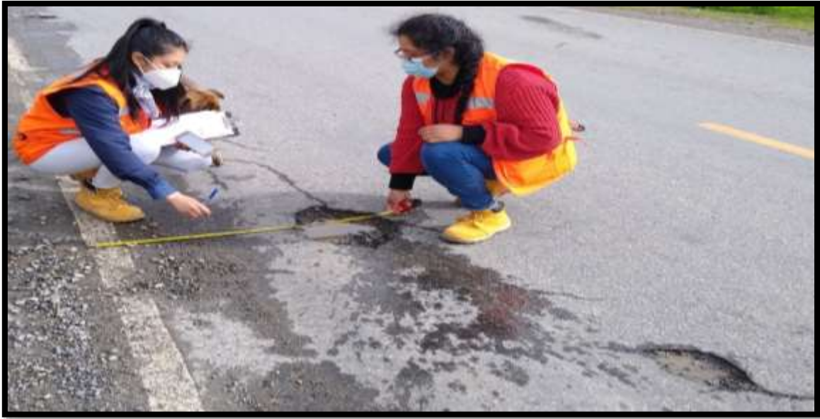
Figura 55. Inspección y medición en falla Bacheo u Huecos
