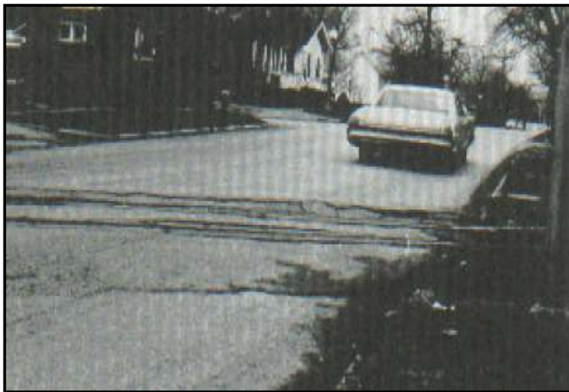
Figura 17. Cruce Vía Férrea de alta severidad
