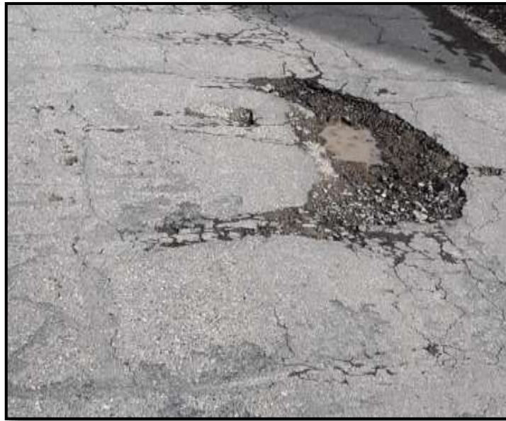
Figura 15. Parcheo de severidad alta
