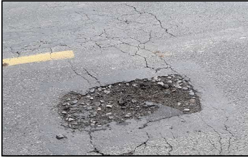
Figura 23. Desprendimiento de agregados
