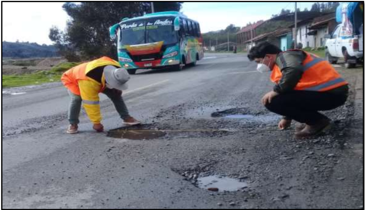
Figura 61. Inspección y calificación de falla tipo bacheo y parcheo con fisura de borde.
