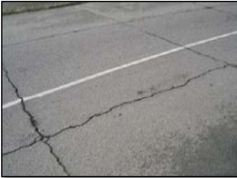
Figura 13. Grieta por reflexión de Junta
