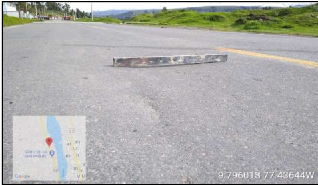
Figura 59. Ubicación de tipo de falla hundimiento acompañado de desintegración de agregados.
