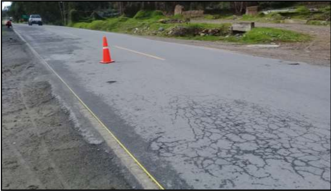
Figura 63. Falla tipo piel de cocodrilo con parcheo.
