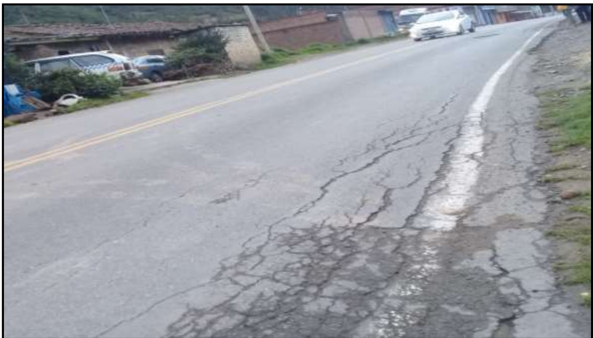
Figura 62. Falla tipo grieta longitudinal y transversal acompañado con fisura de borde.
