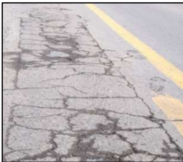
Figura 6. Agrietamiento en Bloque
