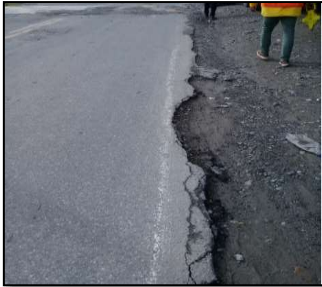
Figura 11. Grieta de borde
