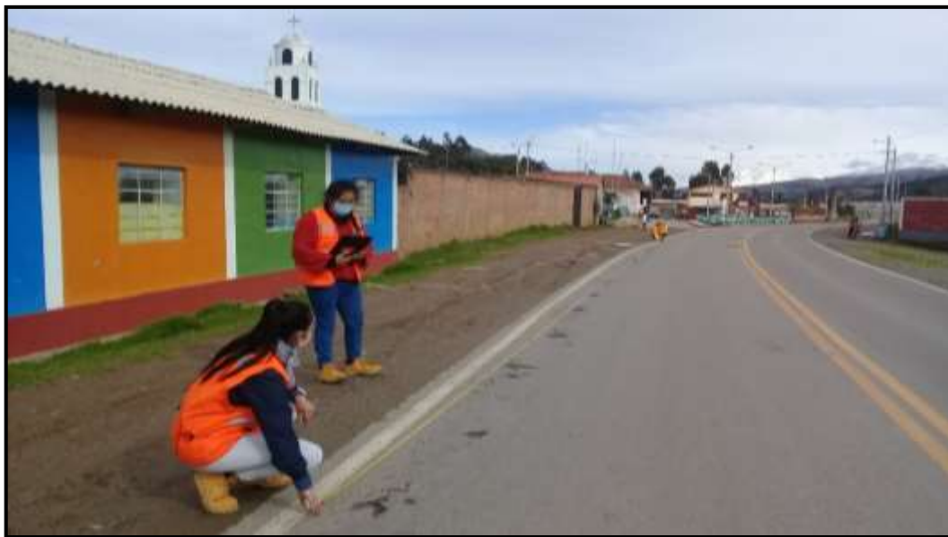
Figura 53. Trabajo de medición y evaluación en tramo con fisuras de borde.
