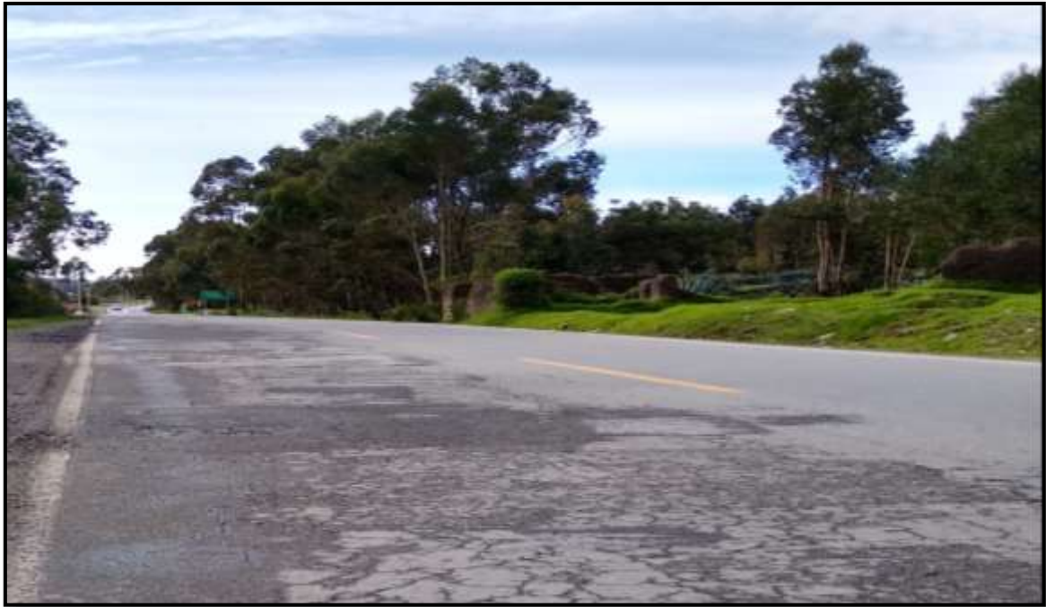
Figura 57. Tipo de falla piel de cocodrilo y parcheo en tramo crítico.
