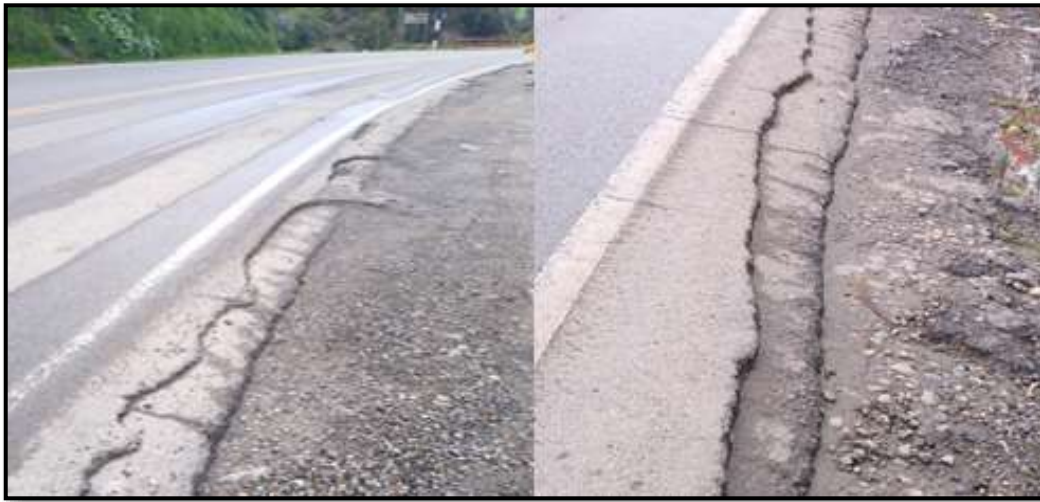
Figura 14. Grieta de reflexión de Junta
