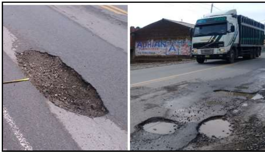
Figura 18. Hueco y Baches severidad media
