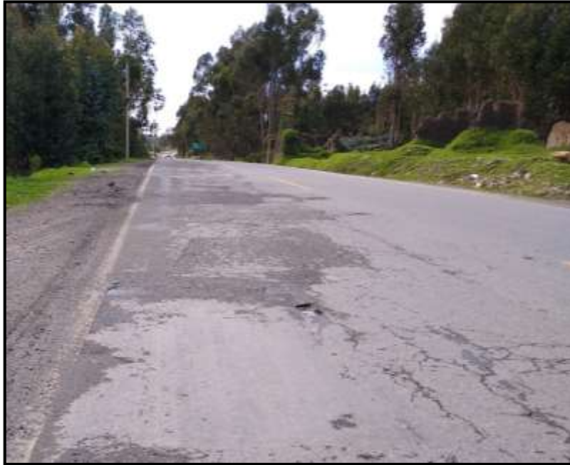
Figura 12. Grieta Longitudinal y transversal
