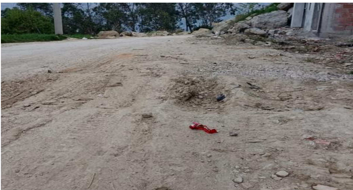
Ahuellamiento de la vía
