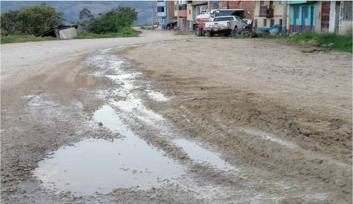
Charcos de agua originadas, notable por las lluvias.
