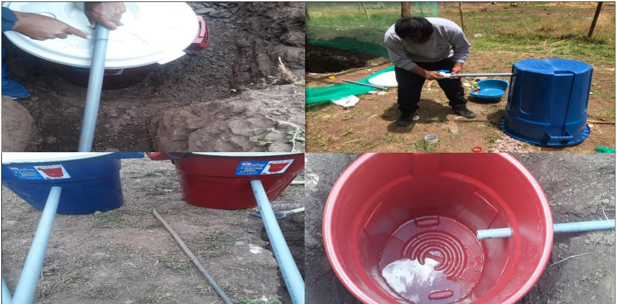
Figura 64. Colocación de tuberías a cilindros de almacenamiento y recepción de los lixiviados.
