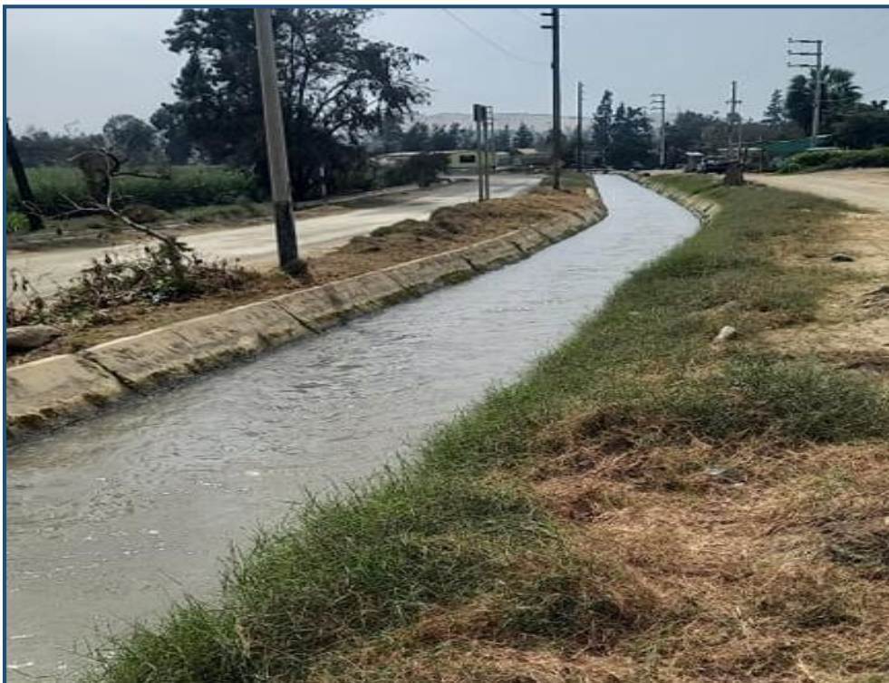
FIGURA N°. 27 PUNTO DE CAPTACIÓN
