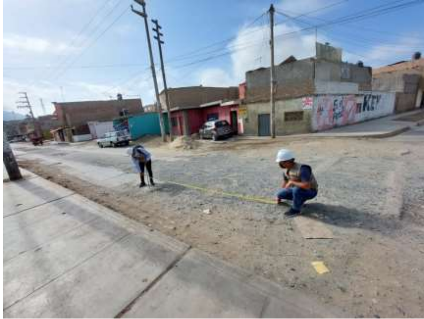
GRÁFICO N°1 – Toma de muestra de desprendimiento de agregados
