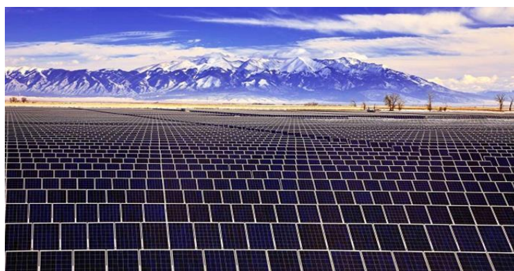
Figura 1. Planta eléctrica solar Rubí, Moquegua
