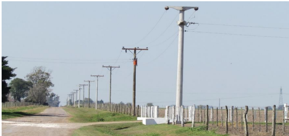
Figura 2. Distribución de energía eléctrica en media tensión.
