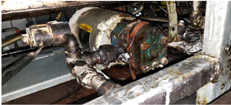
Figura 46. Motor y bomba de filtrado Fuente: Elaboración Propia
