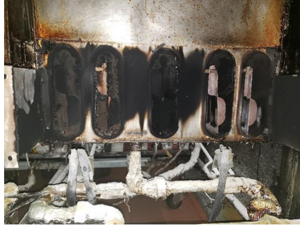
Figura 41. Antes tubos de calor Fuente: Elaboración Propia
