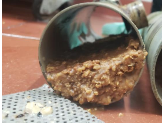
Figura 57. Empaque de drenaje deteriorado
