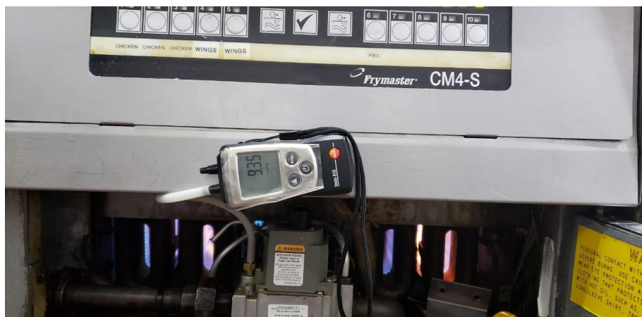
Figura 28. Medición de presión de trabajo del equipo Fuente: Propia
