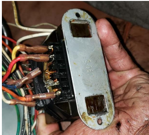
Figura 49. Antes transformador Fuente: Elaboración Propia
