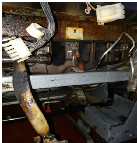
Figura 51. Cables de alimentacion Fuente: Elaboración Propia
