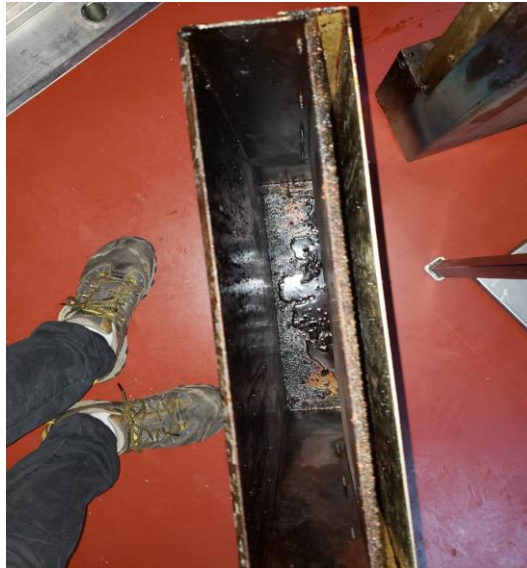
Figura 52. Chimenea sucia Fuente: Elaboración Propia
