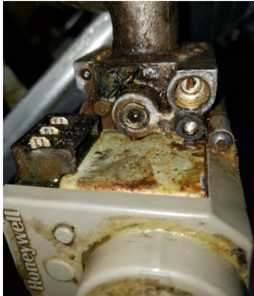
Figura 44. Antes Válvula de gas Fuente: Elaboración Propia
