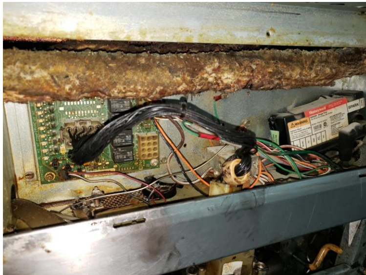
Figura 61. Fibra de vidrio deteriorada Fuente: Elaboración Propia
