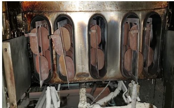
Figura 42. Después tubos de calor Fuente: Elaboración Propia
