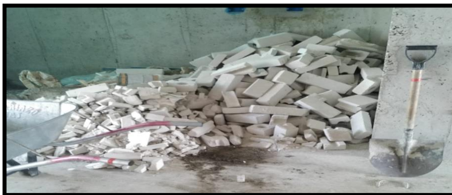
Figura 1. Desperdicios en obra del ladrillo Sílico Calcáreo de un piso
