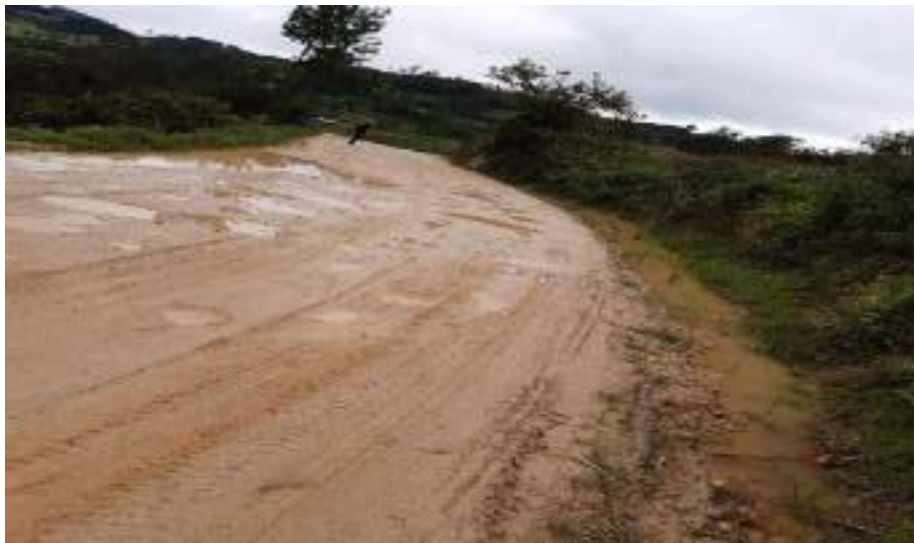
Figura 35: Trocha carrozable con superficie de rodadura en mal estado.
