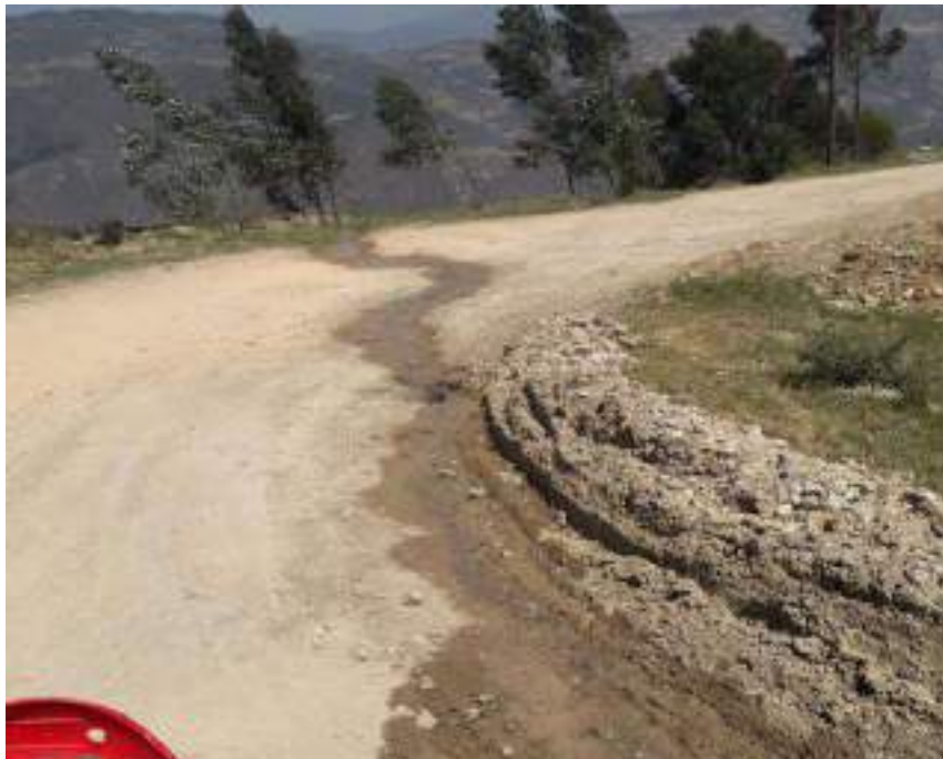
Figura 36: Ausencia de obras de arte y de drenaje, la cual perjudica la vía en épocas de lluvia.
