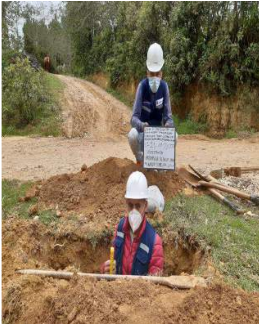
FOTOGRAFIA 21: Se Observa La Toma De Muestras De La C - 21 Para La Tesis: " Diseño De Infraestructura Vial Para Mejorar La Transitabilidad Vehicular Tramo Cutervo –San José De Cullanmayo Km. 00+000 Al Km.10+360, Cajamarca"
