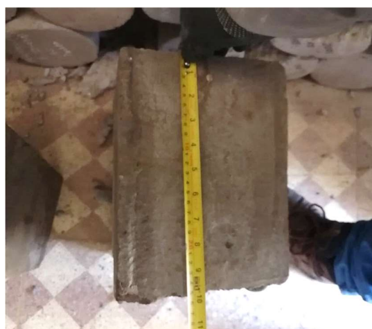
Figura 21: Medida falla en la viga
