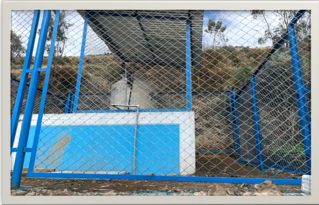
FOTOGRAFIA 01: IMAGEN DEL RESERVORIO EXISTENTE DEL SECTOR DE HUELLAP
