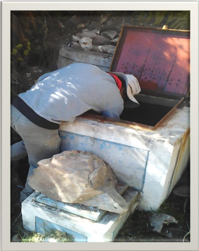
FOTOGRAFIA 03: Captación en estado malo
