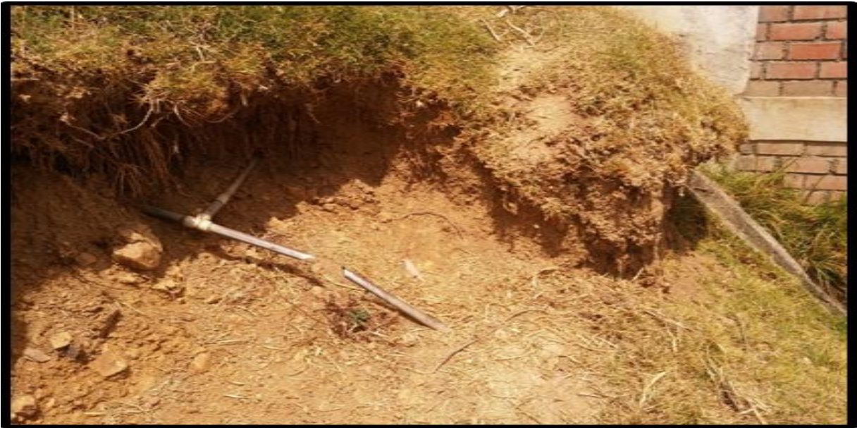
Fotografía : Red de distribución expuesta
