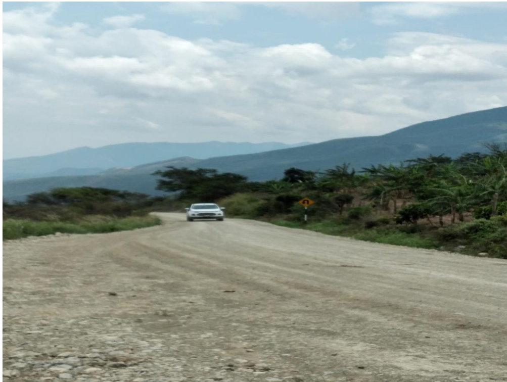
FIGURA 5: Tramo Nueva Victoria – Espital, Km. 0+000 al Km. 5+960, Amazonas –Vista panorámica del estado actual por tramo (Km 5+100), 2021.
