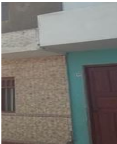
Figura 19. Viviendas sin juntas de dilatación
