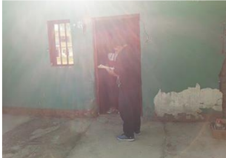
Figura 23. viviendas dañadas por la humedad
