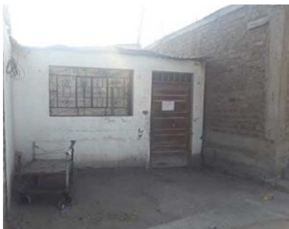
Figura 21. estado de la estructura de unas de las viviendas
