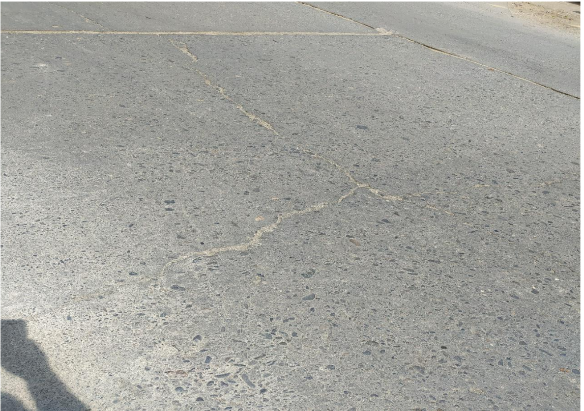
DESCONCHAMIENTO, MAPA DE GRIETAS
