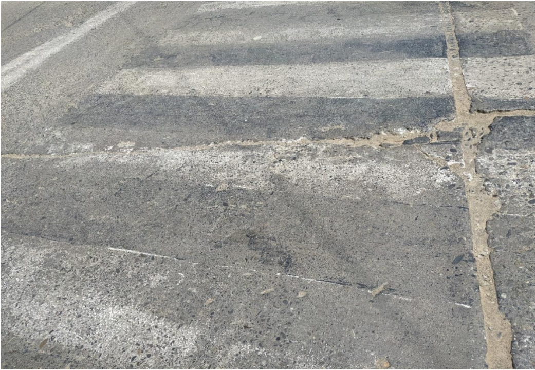
GRIETA LINEAL LONGITUDINAL
