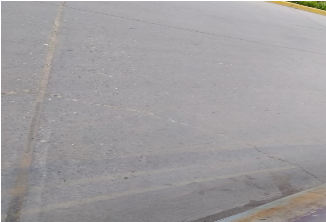
GRIETA DE ESQUINA
