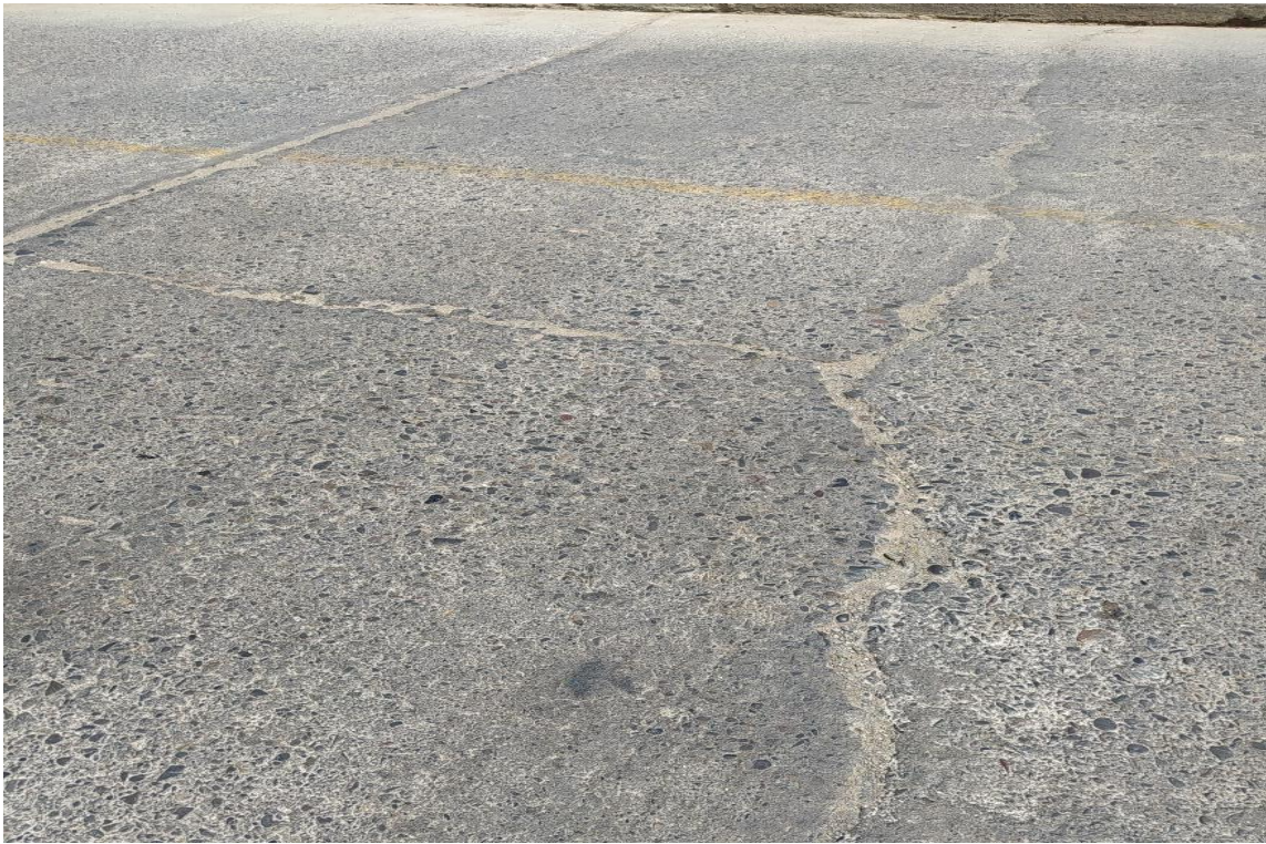
GRIETA LINEAL TRANSVERSAL
