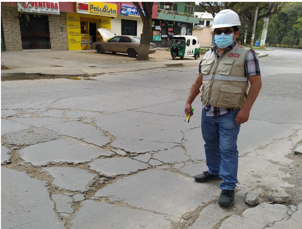
IDENTIFICACION DE DAÑOS EN LA CALLE MALECÓN DANIEL ALOMÍA ROBLES - HUÁNUCO
