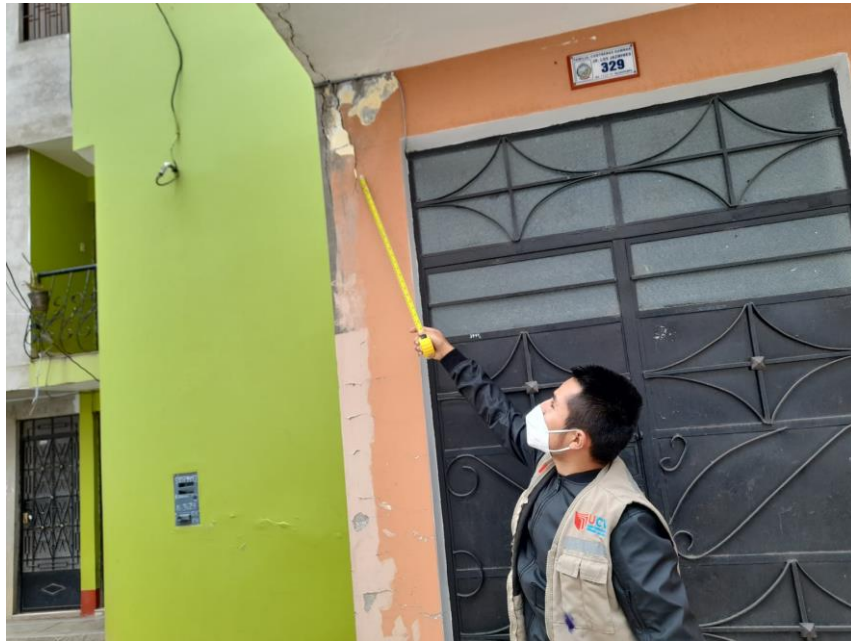
Figura 20: presencia de grietas y deterioro en columnas
