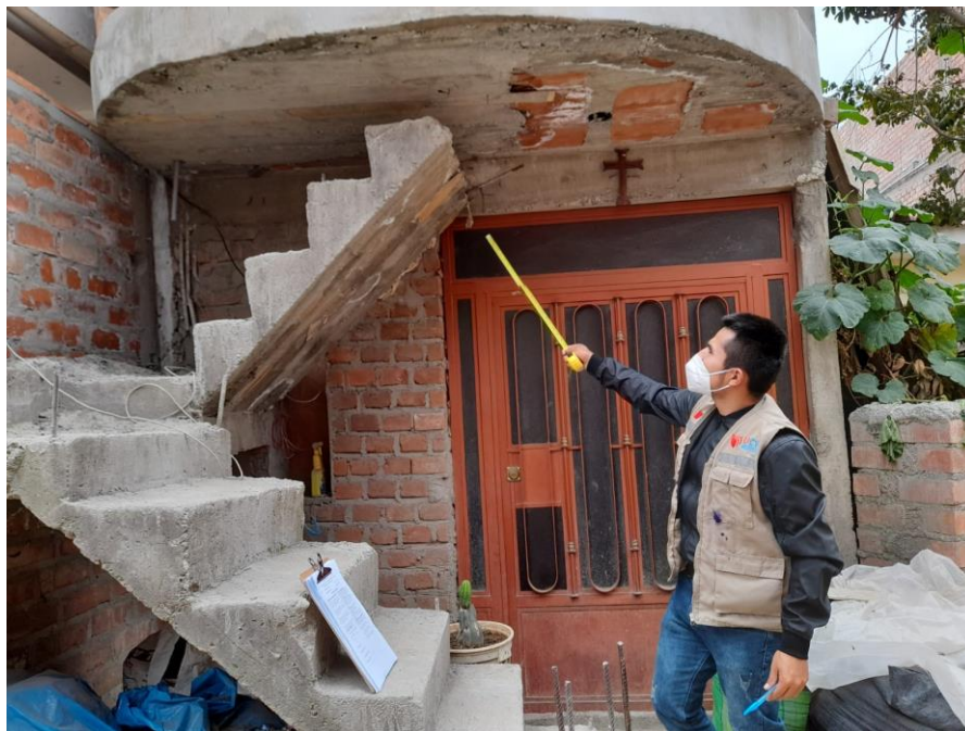
Figura 23: presencia de error estructural en el proceso constructivo de las viviendas autoconstruidas
