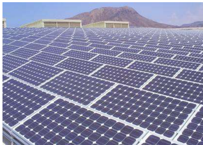
Figura: Paneles solares
