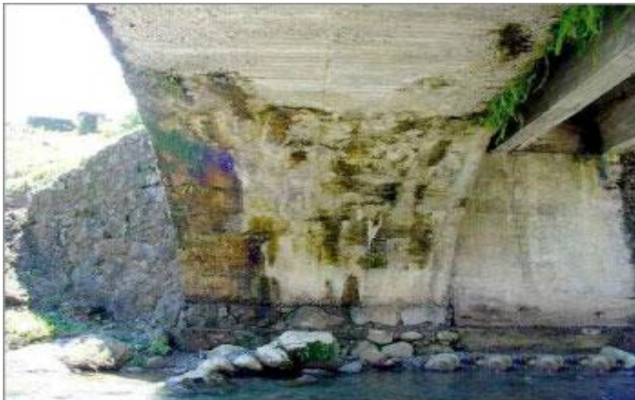
Eflorescencia en Arco de Puente
