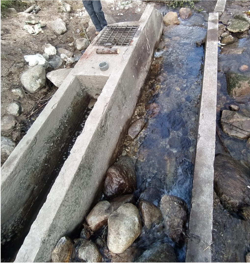
Ilustración 2: Estado del barrage lateral.
