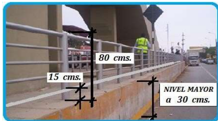
Borde de un piso transitable, abierto hacia un plano inferior con diferencia de nivel de 30 cms.
