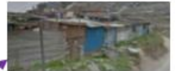
Zona para mercado, en mal estado de conservación.
