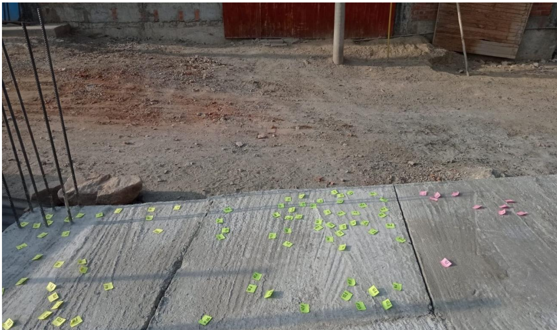
Figura 38: Losas aligeradas con identificación de fisuras de los paños de prueba 2.
