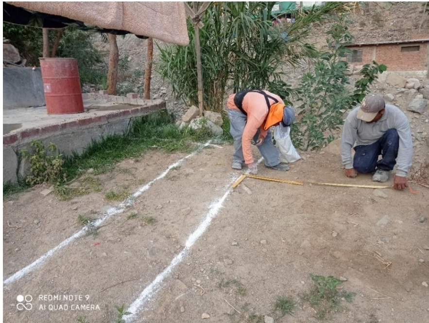
Figura 20: Replanteo para la construcción de las losas aligeradas de los paños de prueba 1.
