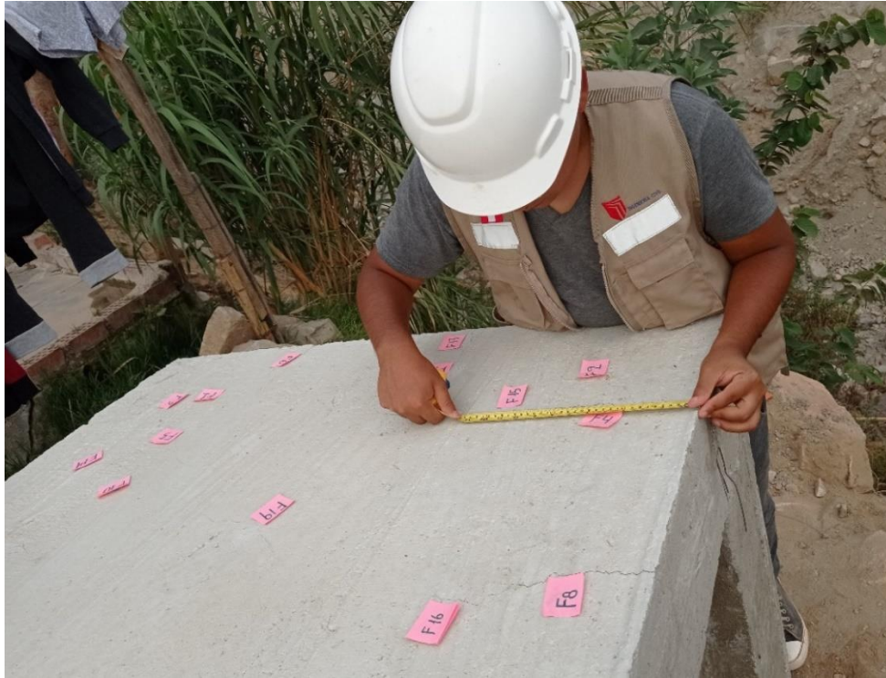
Figura 37: Medición de la longitud de las fisuras de los paños de prueba 1 con el flexómetro.
