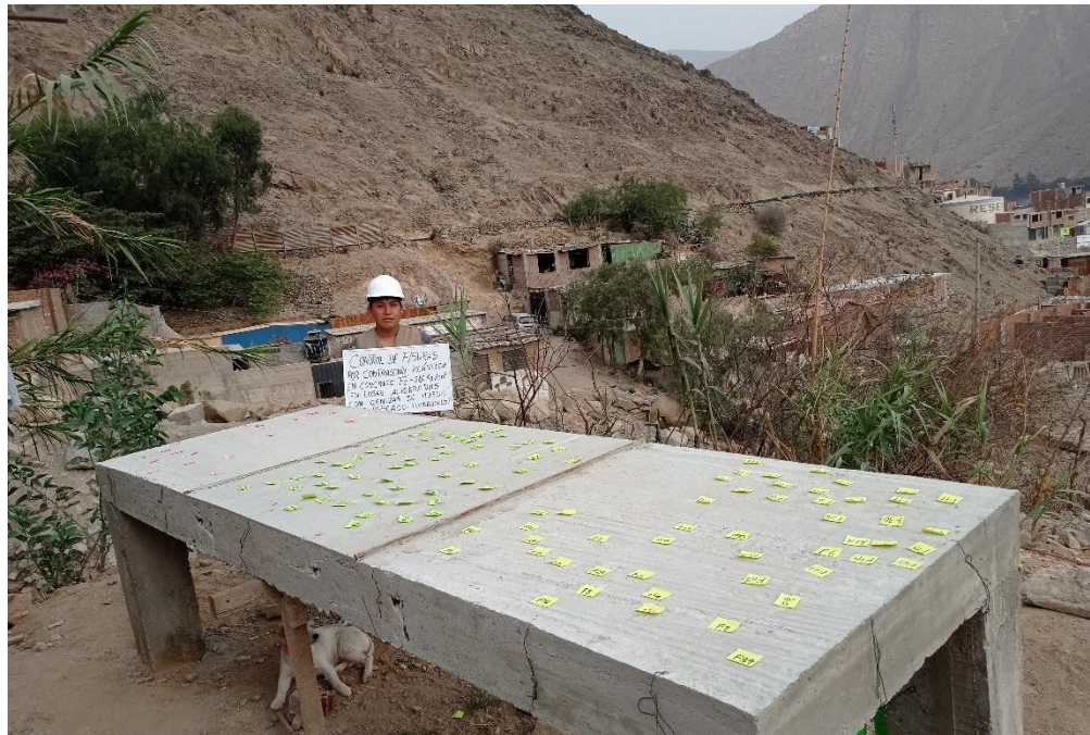
Figura 32: Losas aligeradas con identificación de fisuras de los paños de prueba 1.
