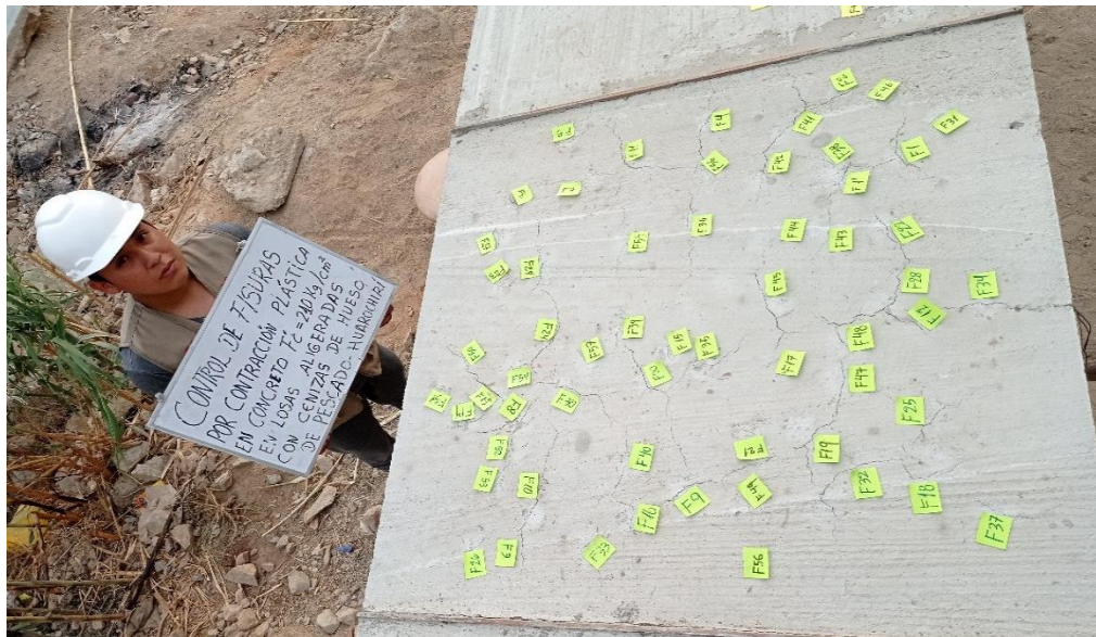
Figura 34: Losa aligerada con 3% de ceniza de hueso de pescado (Paño de prueba 1).
