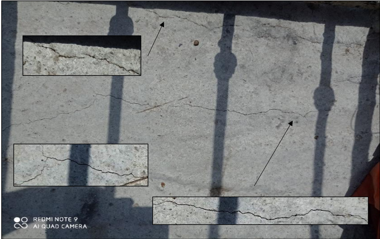
Figura 2: Plano de fisura por retracción plástica en losa aligerada.
