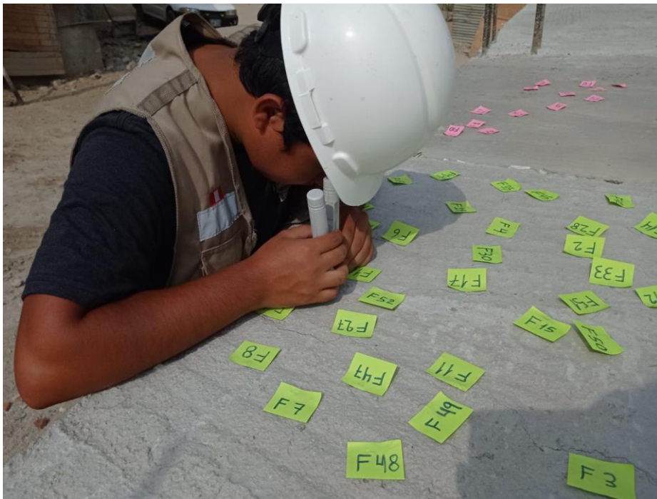
Figura 42: Medición del espesor de las fisuras de los paños de prueba 2 con el fisurómetro.
