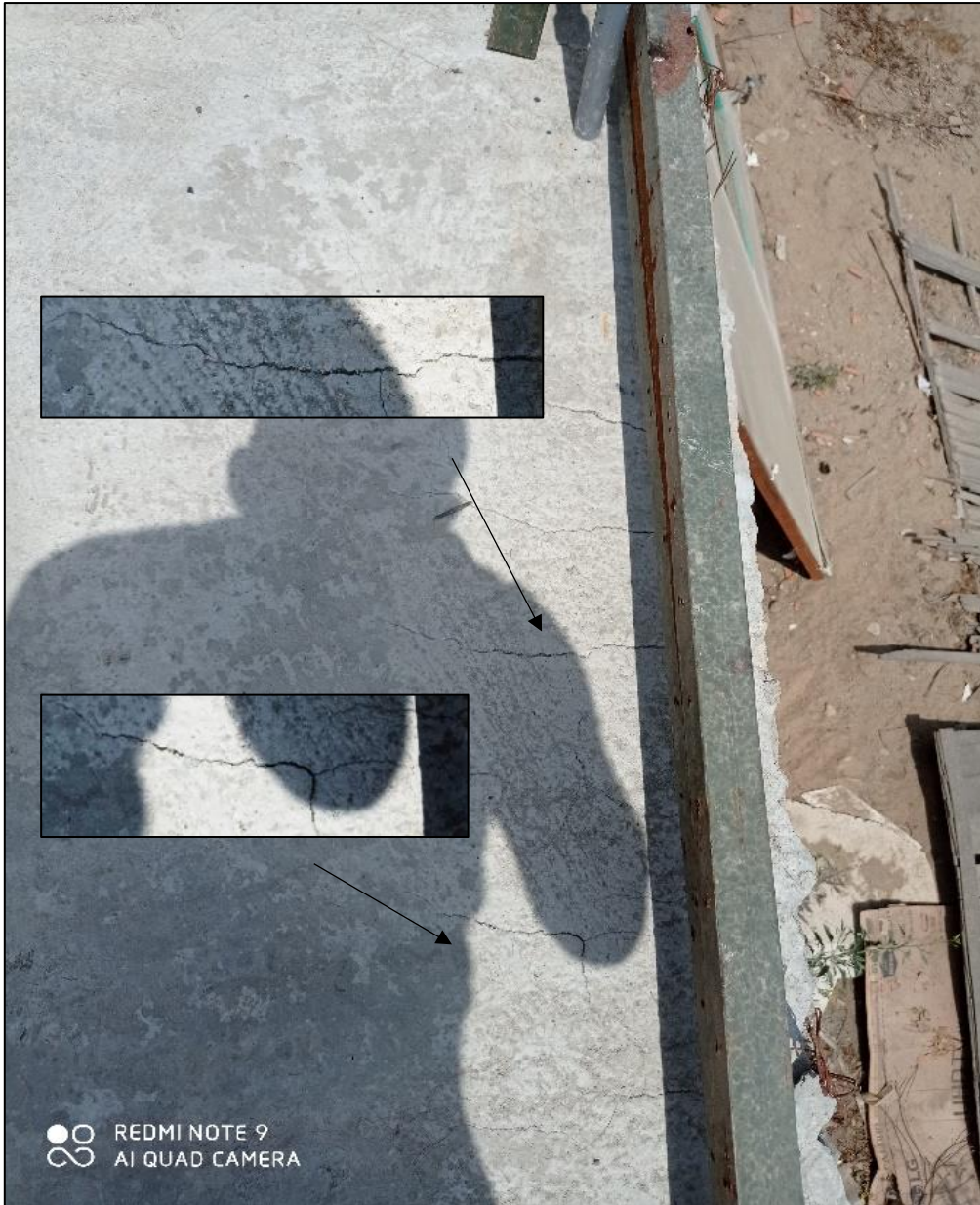
Figura 1: Plano de fisura por retracción plástica en losa aligerada.
