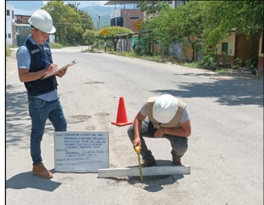
Figura 6. Identificación de falla baches/huecos
