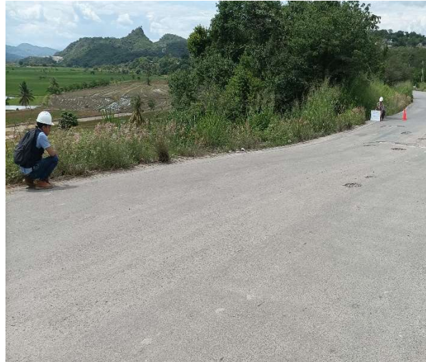
Figura 25. Identificación de fallas mediante el método PCI
