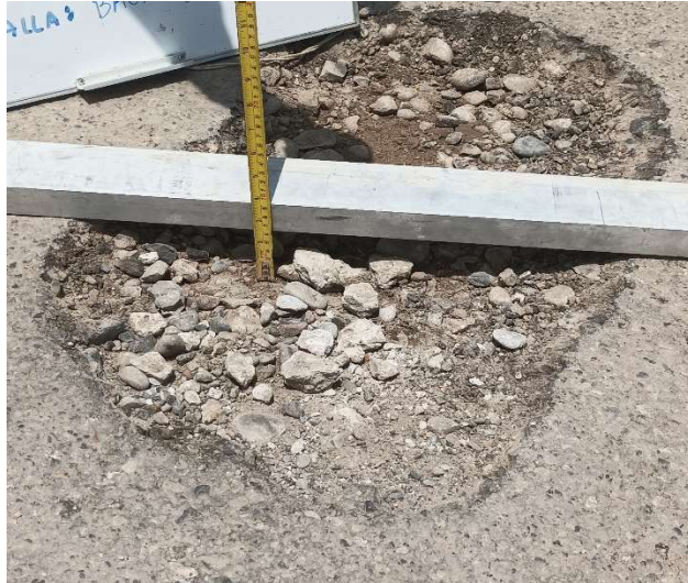
Figura 28. Identificación de fallas mediante el método VIZIR
