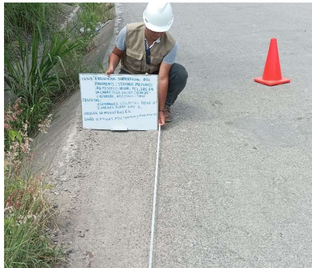
Figura 26. Identificación de fallas mediante el método PCI
