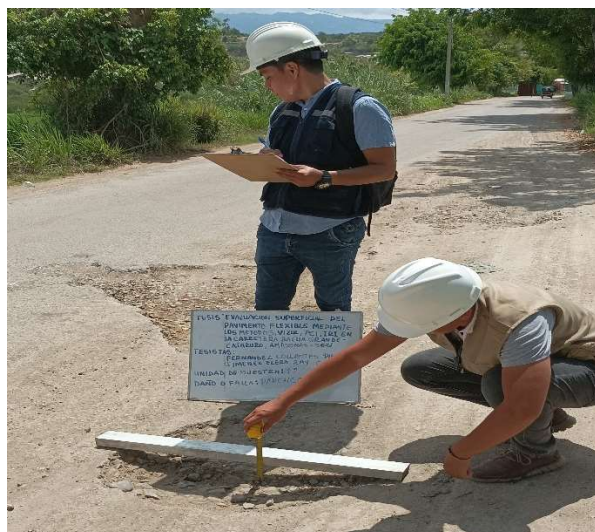
Figura 24. Identificación de fallas mediante el método PCI
