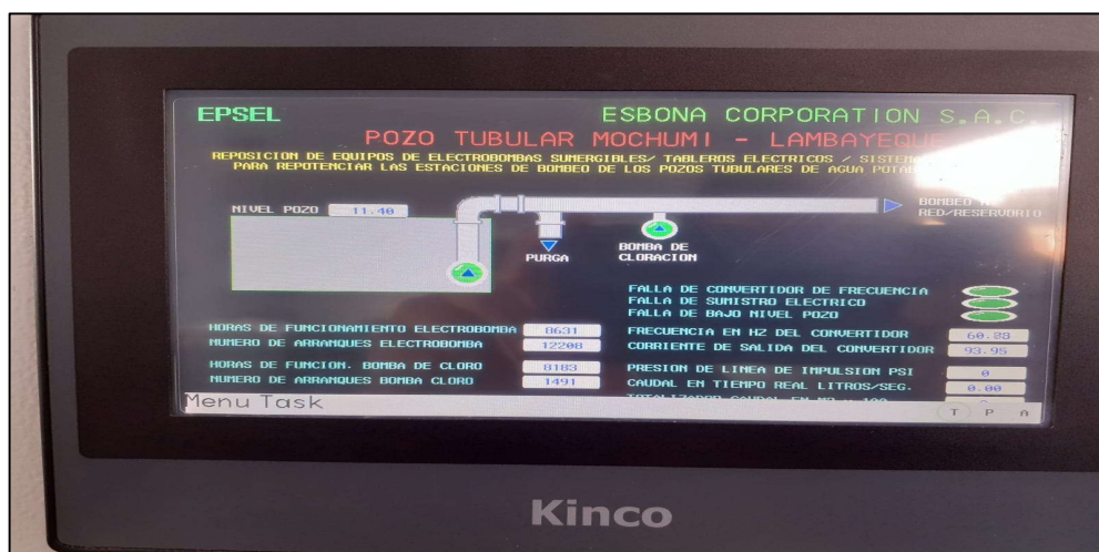
Foto 3. Sistema de control de Pozo Tepo.
