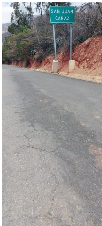
Figura 1. Condición del pavimento actual
