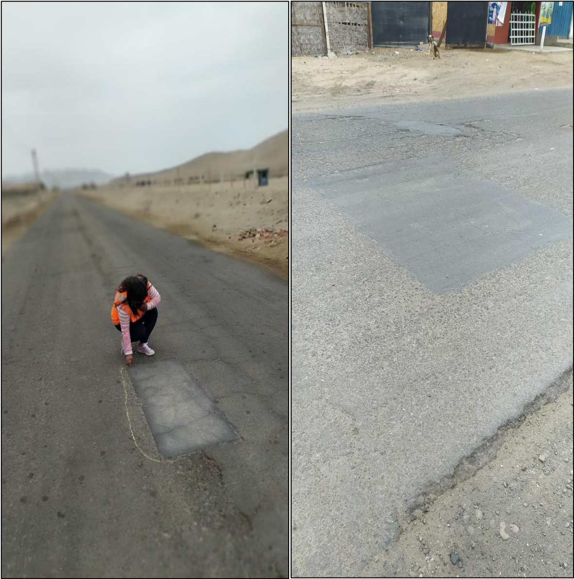
Estado actual de la Avenida Antigua Panamericana Sur
