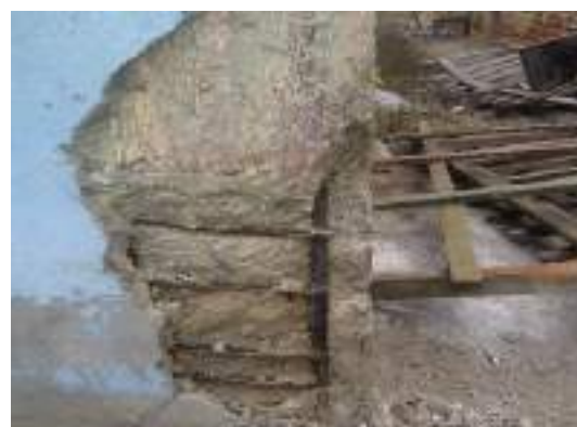
DEFICIENCIAS EN LAS COLUMNAS
