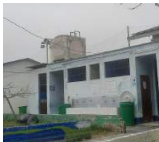
TANQUE ELEVADO INHABILITADO
