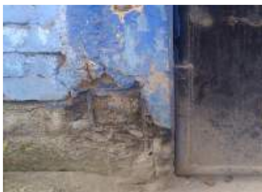
DEFICIENCIAS EN LAS COLUMNAS
