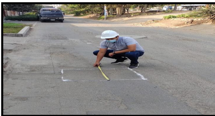
Figura N°07: Evaluación de falla Parche Fuente: Elaboración Propia
