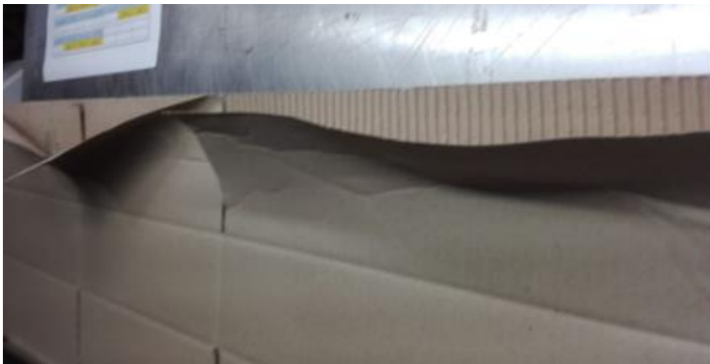
Figura 15. Lámina despegada por falta de goma.
