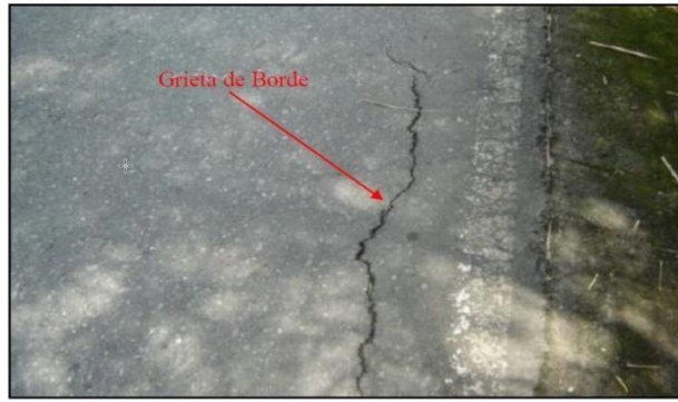
Figura 5. Grieta de borde
