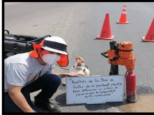
Figura 20. Equipos de extracción y Seguridad Fuente: Elaboración propia
