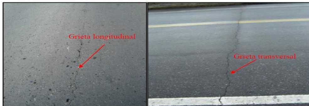
Figura 6. Grietas longitudinales y transversales
