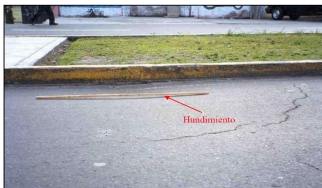
Figura 4. Abultamientos y Hundimientos
