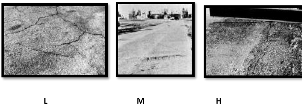
Figura 7. Abultamiento y hundimientos.
