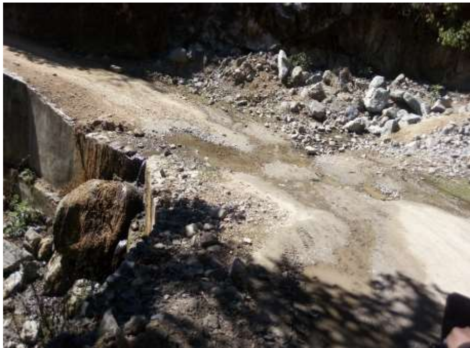
La capa de rodadura dañada
