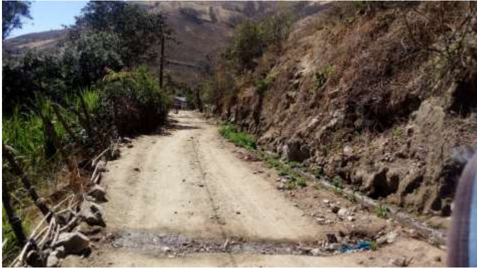
La capa de rodadura dañada
