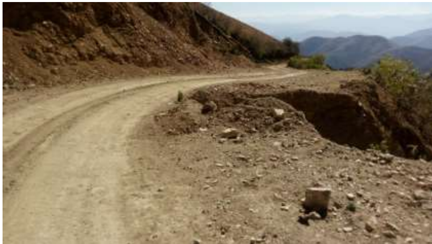
Los taludes están erosionados y requieren ser Recuperados.
