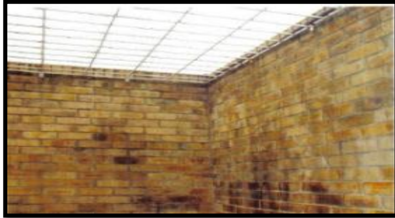
Figura 6: Suciedad Causada por la Escorrentía del Agua Lluvia Sobre el Muro (Fuente: González, 2012).
