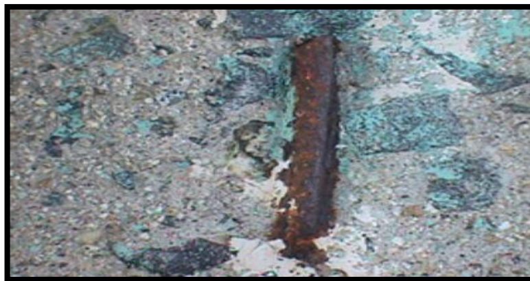
Figura 9: Oxidación de Armaduras (Fuente: Florentín y Granada, 2009).
