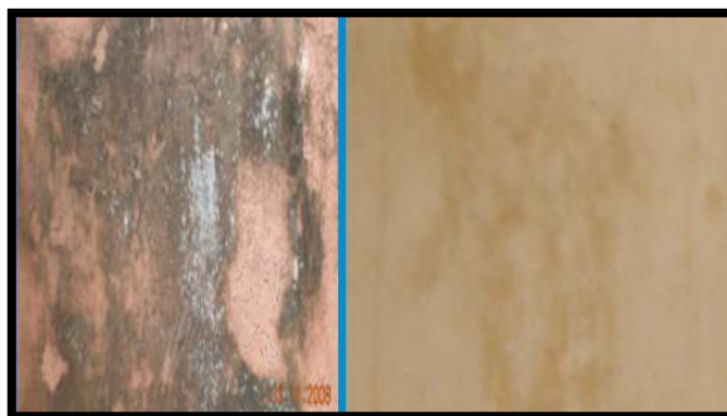
Figura 5: Manchas de Humedad (Fuente: Florentín y Granada, 2009).
