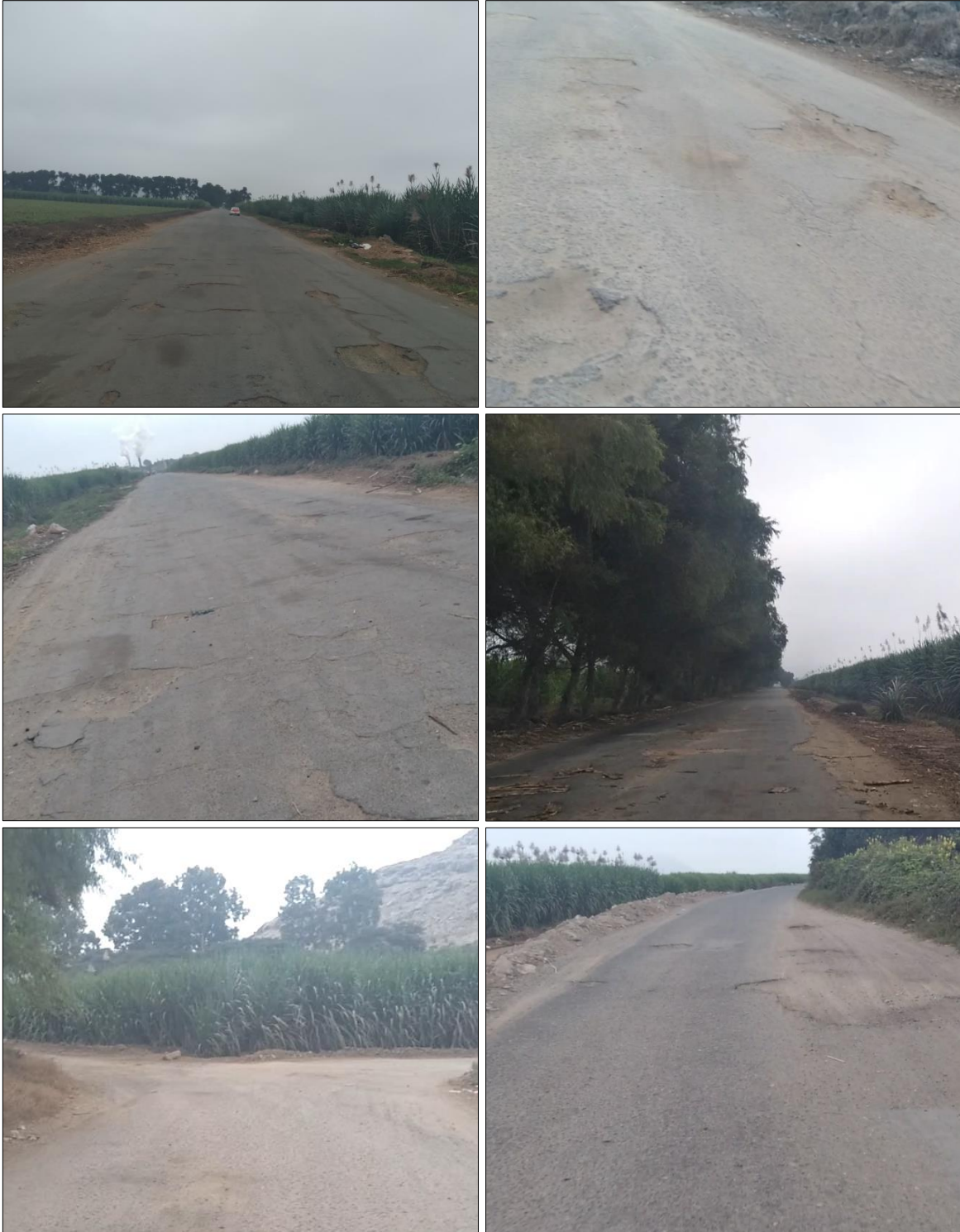
Imagen 9.2.1 – Estado situacional de la vía pavimentada
