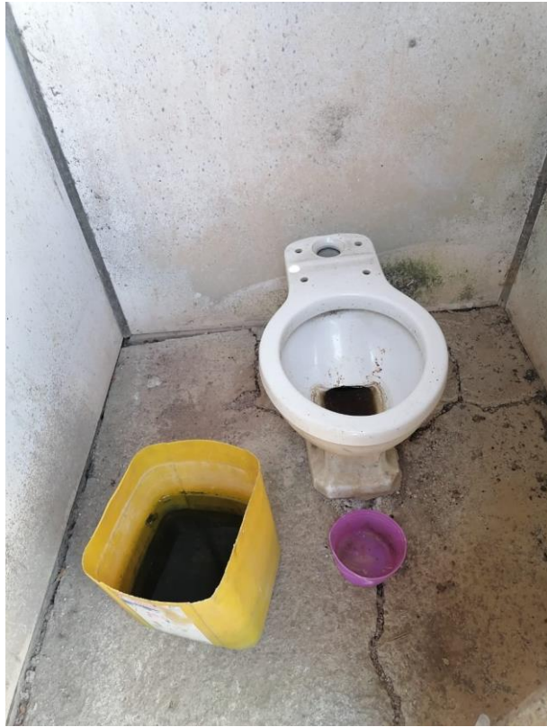
Servicio higiénico del puesto de repliegue “Sargento Figueroa”
