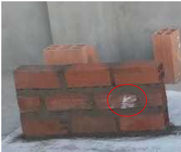
fotografía 40: eflorescencias en ladrillo
