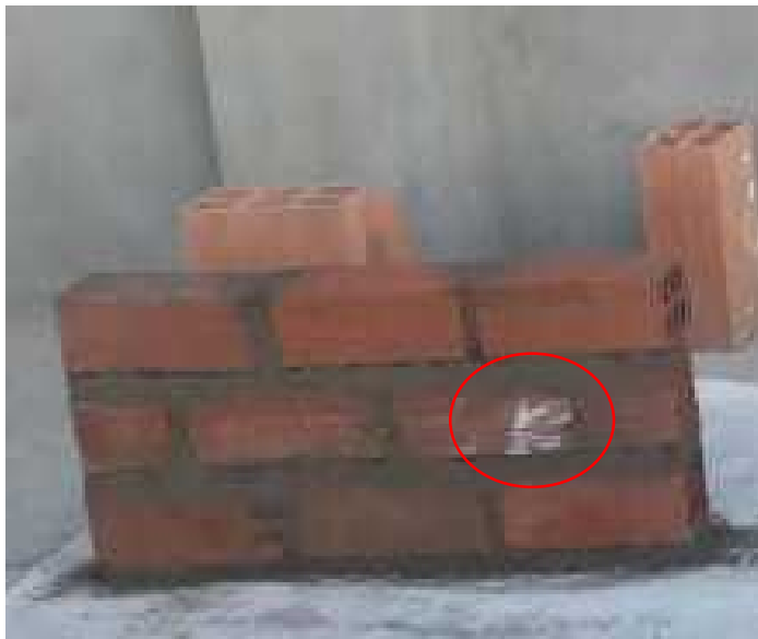
fotografía 40: eflorescencias en ladrillo
