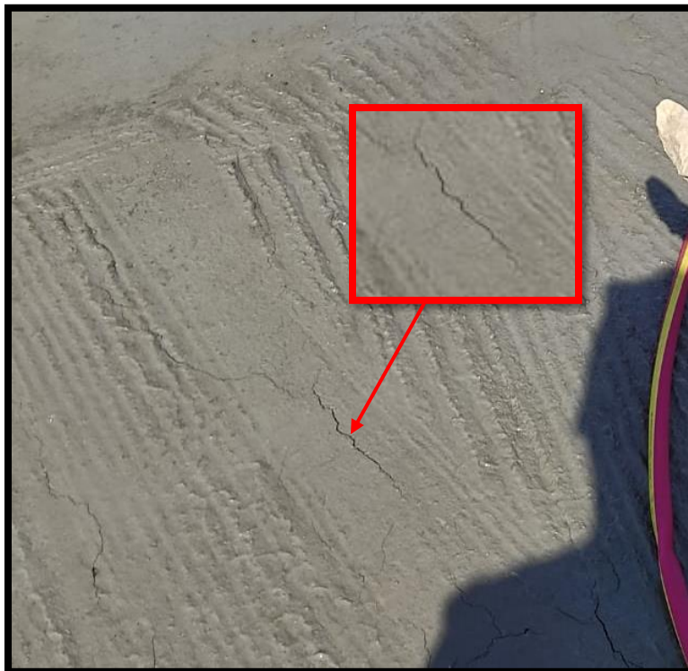
Figura 2: Foto a detalle de la problemática
