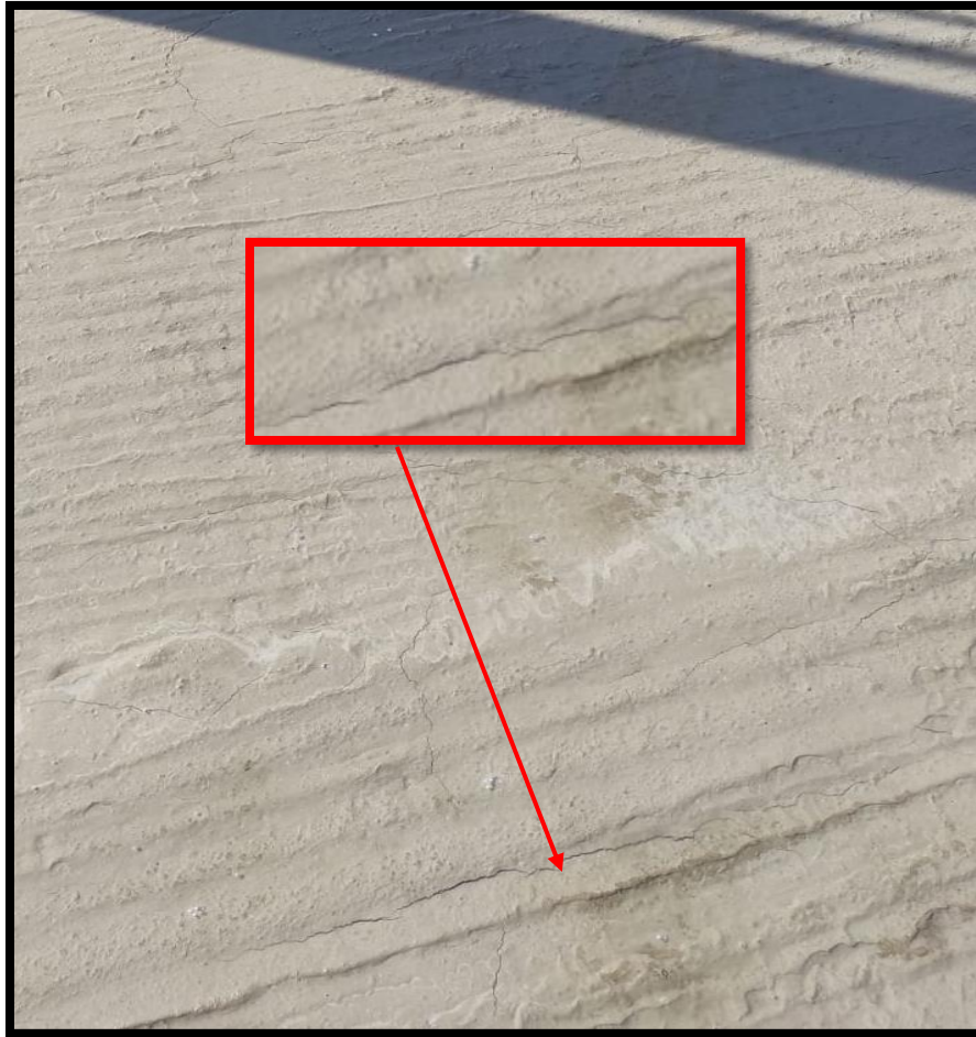
Figura 3: Foto a detalle de la problemática
