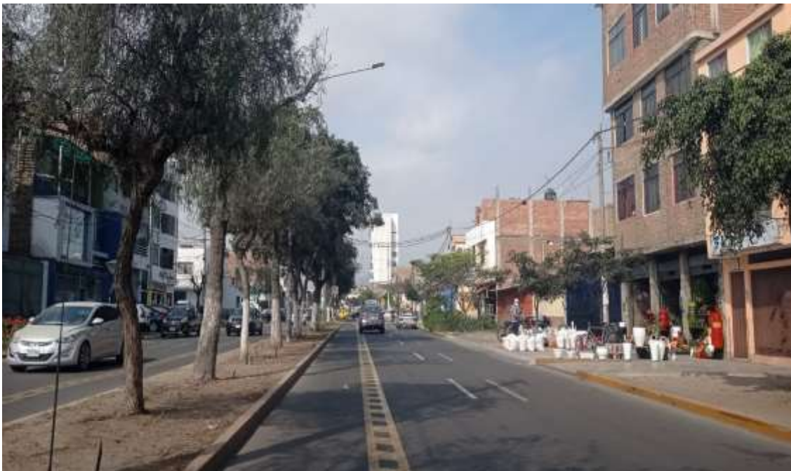
Figura 4: Vista fotográfica de la obra de Rehabilitación de la Av. Miraflores ejecutada por la Autoridad para la Reconstrucción con Cambios, diciembre 2021.
