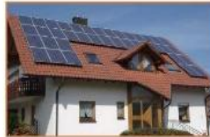
Aislada sistema solar casero
