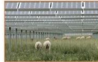
Granja solar de generación
