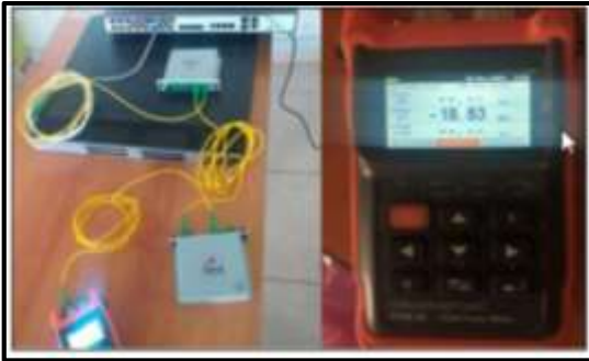
Figura 48: Medición de potencias de equipos
