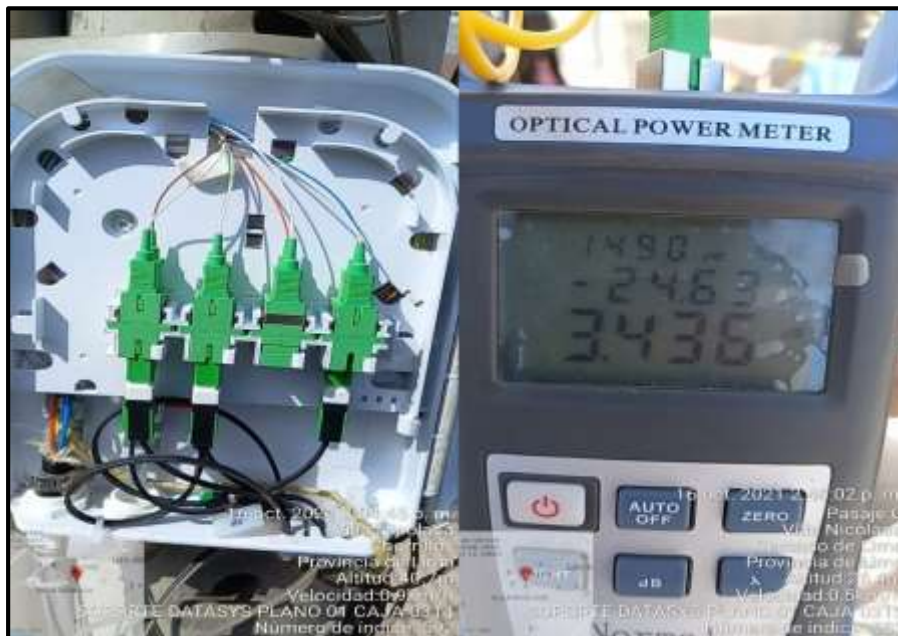
Figura 51: Medición de caja de distribución
