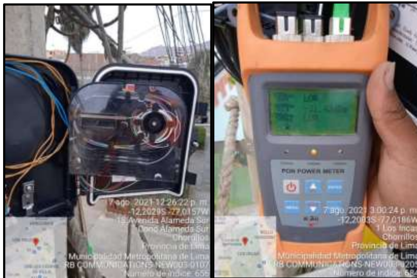
Figura 49: Medición de caja de distribución
