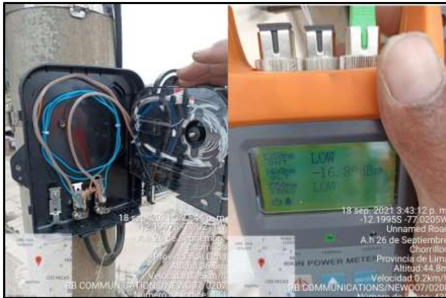
Figura 50: Medición de caja de distribución del plano 1
