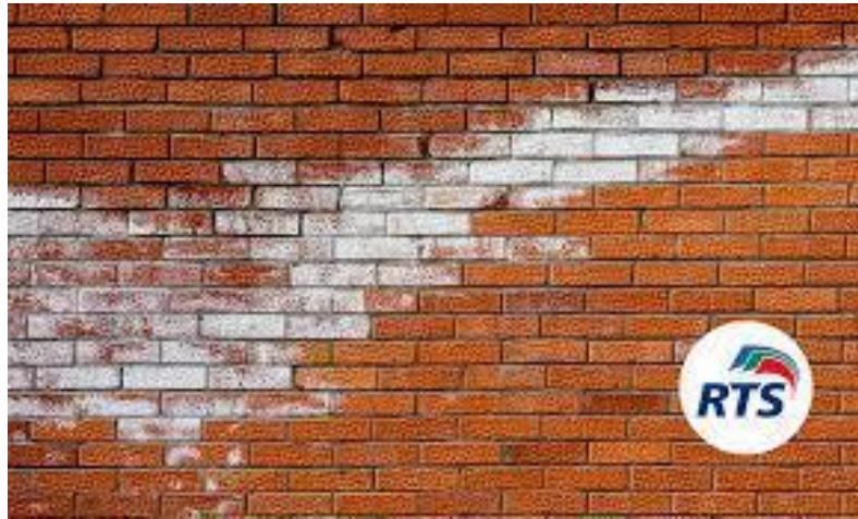
Figura N°7: Eflorescencia en muros de albañilería
