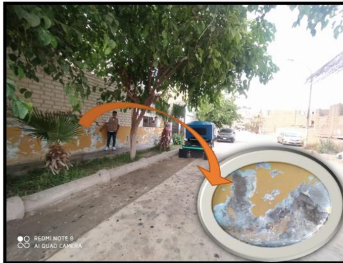
Figura N°01. Problemática de la baja resistencia de los morteros y la permeabilidad que lo ataca al mortero.
