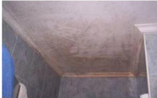
Figura N° 8: Humedad por condensación
