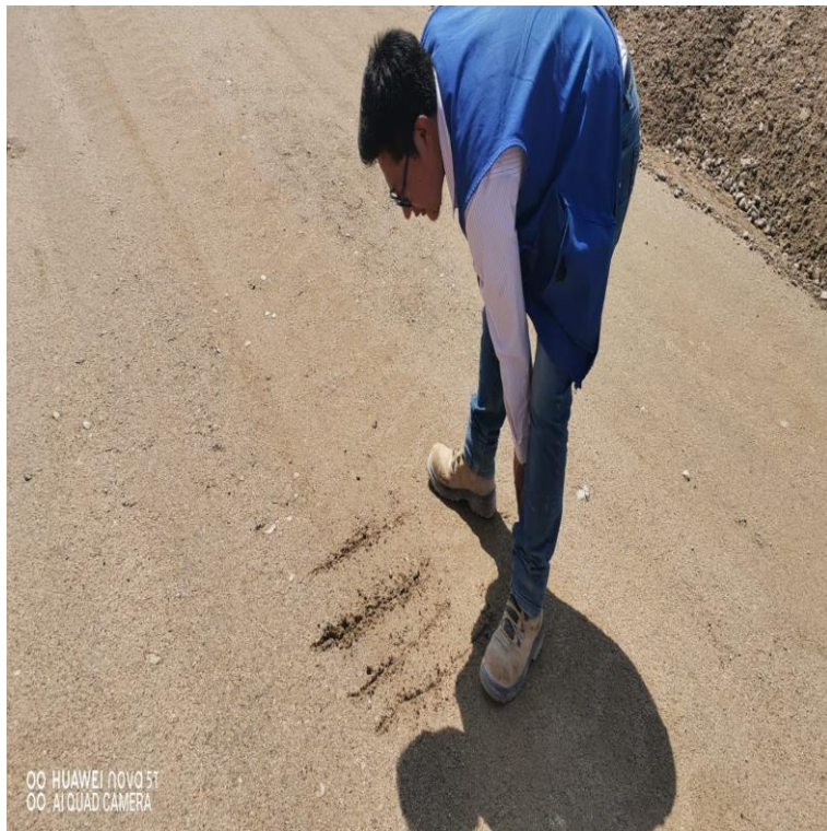
Figura 44: Material de base y subrasante en mal estado
