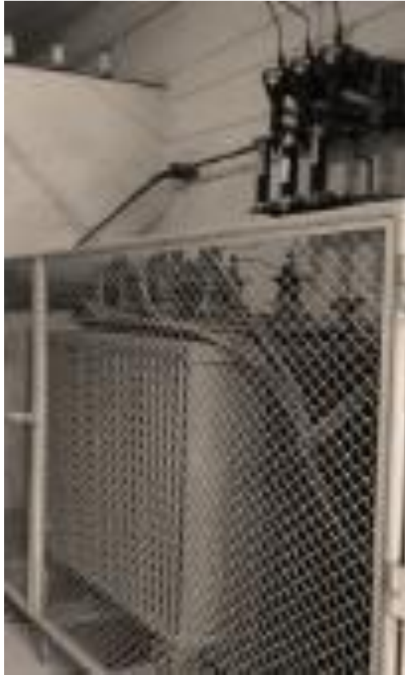
Figura 6. Transformador trifásico (distribución)
