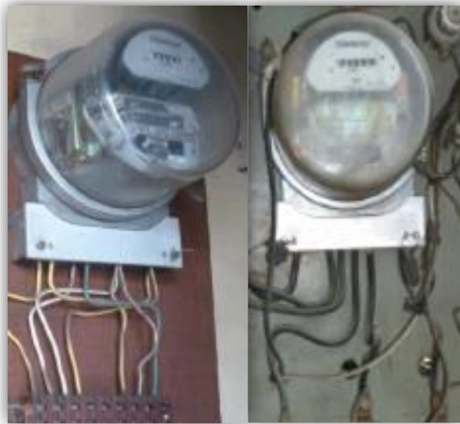
Figura 9. Medidores de distribución de acometidas y medidor de alumbrado.
