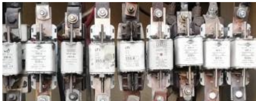
Figura 5. Fusibles – tensión baja.
