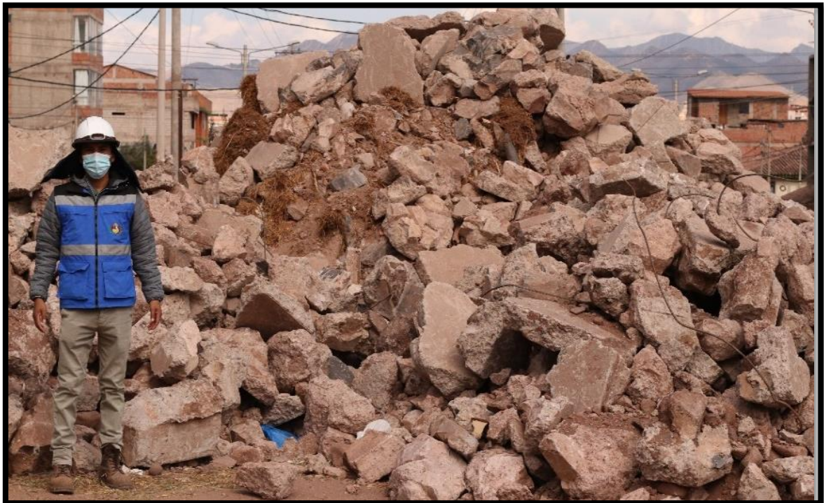
Figura 03. Estado en el que se encuentra el material (concreto) proveniente de la demolición de la vía Expresa
