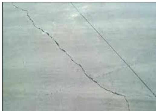
Figura 2. Grietas pavimento rígido Fuente : Blog invias 4
