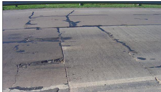
Figura 1 Fallas Pavimento rígido Fuente: Blog ingeniera civil 3
