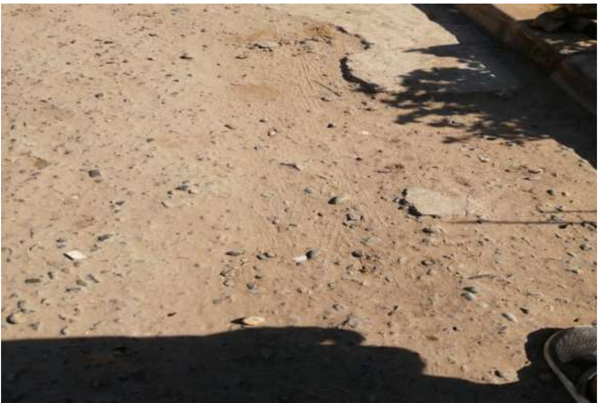
Fotografía 70: Verificación de baches
