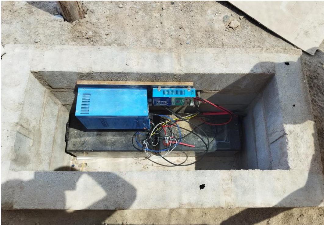
Reconocimiento de Instalaciones de Baterías, Controlador e inversor de corriente.
