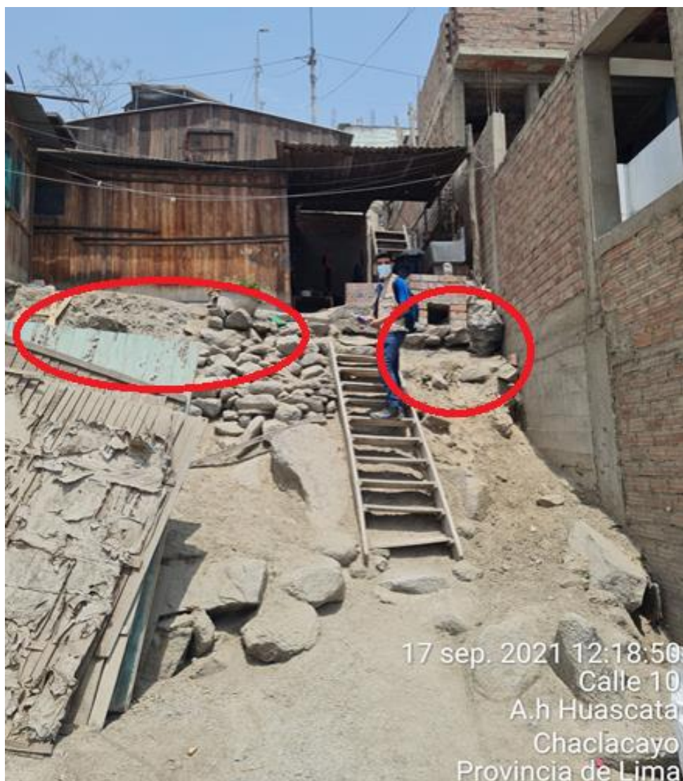
Figura 12. Falla Estructural por Desprendimiento
