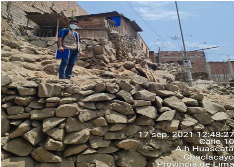
Figura 17. Vulnerabilidad en Vivienda de Madera en Ladera
