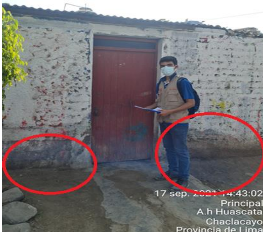
Figura 23. Vivienda Afectada por Humedad
