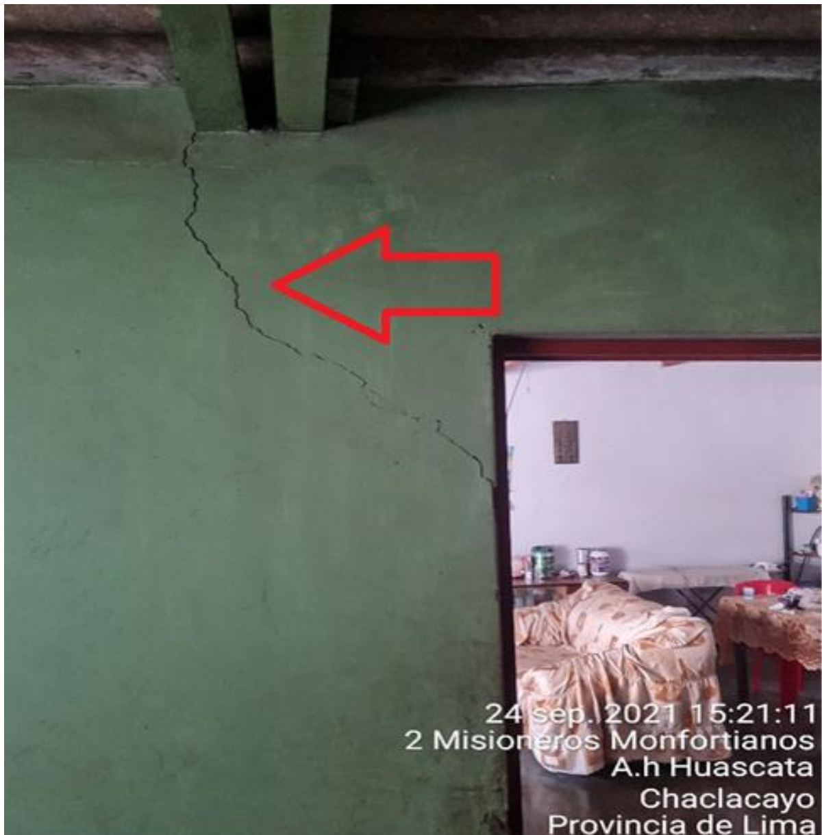
Figura 19. Grieta en Muro Portante de Albañilería
