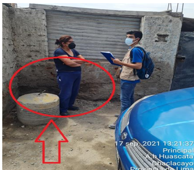
Figura 10. Falla Estructural por Humedad
