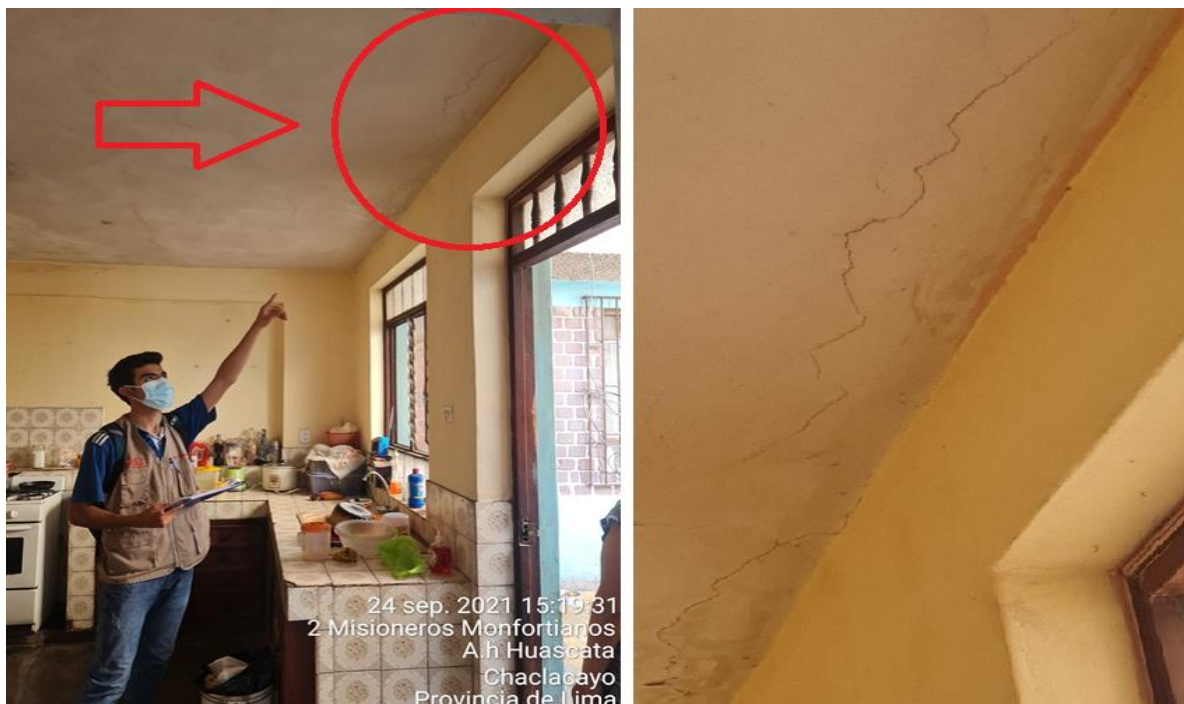
Figura 21. Grieta en Losa Aligerada
