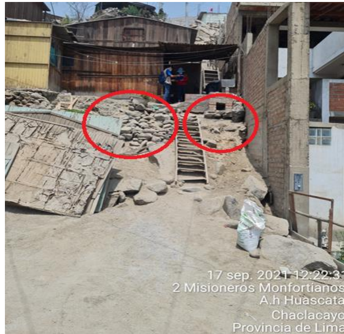
Figura 24. Vivienda Afectada por Erosión y Desprendimiento
