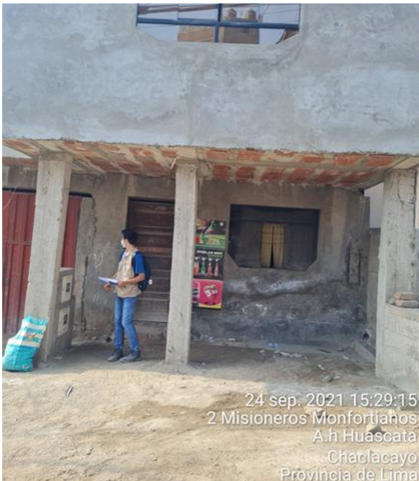
Figura 15. Vulnerabilidad Sísmica en vivienda de concreto armado en ladera empinada
