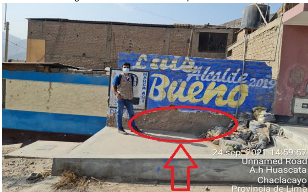
Figura 11. Falla Estructural por Erosión
