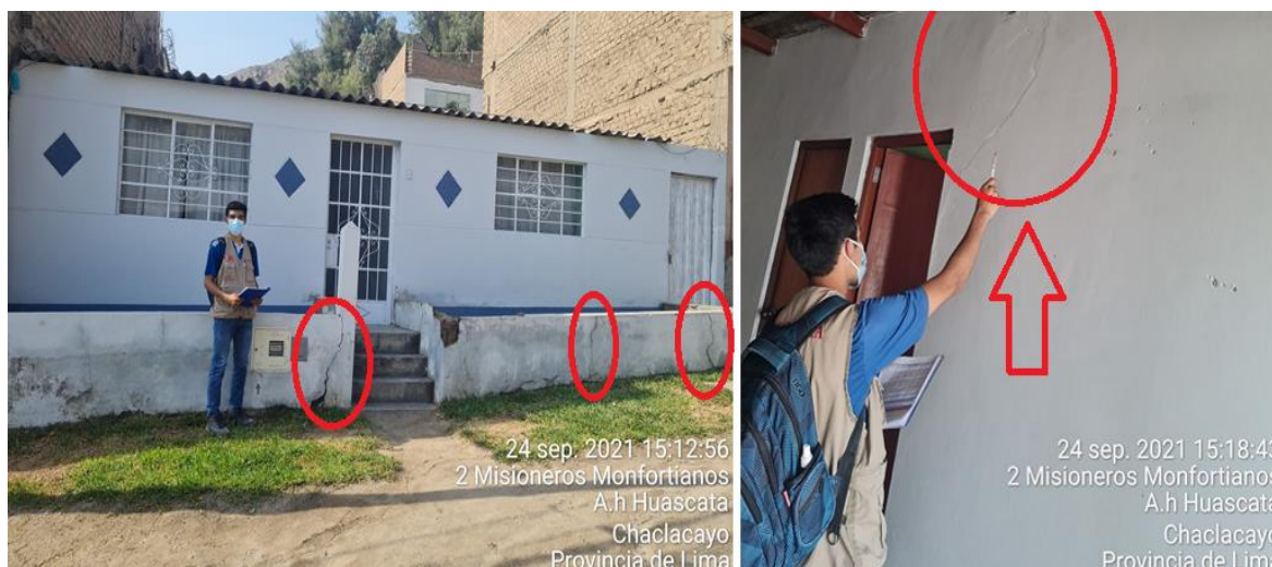
Figura 9. Falla Estructural por Grietas
